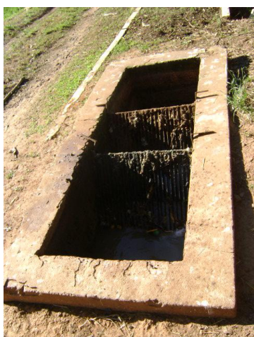
FOTO 4.22 - ETE ITAPORANGA – VISTA DO GRADEAMENTO
