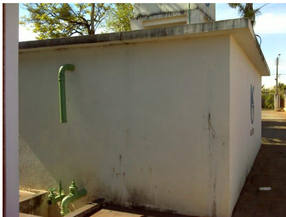
FOTO 4.10 – RESERVATÓRIO APOIADO SANTO ANTONIO
