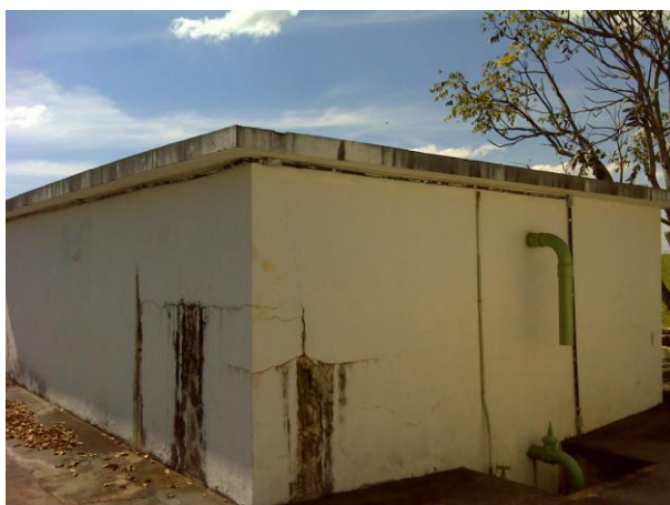
FOTO 4.14 – RESERVATÓRIO APOIADO RIBEIRÃO BRANCO
