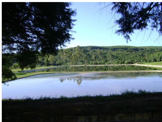
FOTO 4.23 - LAGOA ANAERÓBIA E LAGOA FACULTATIVA DA ETE ITAPORANGA
