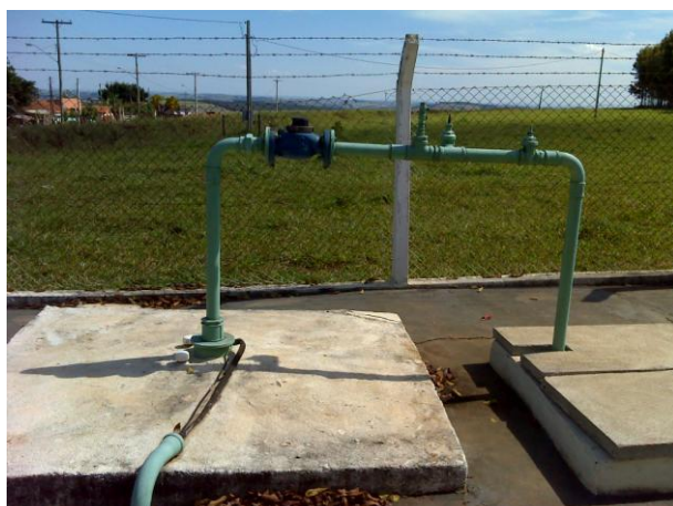
FOTO 4.13 – POÇO PROFUNDO RIBEIRÃO BRANCO
