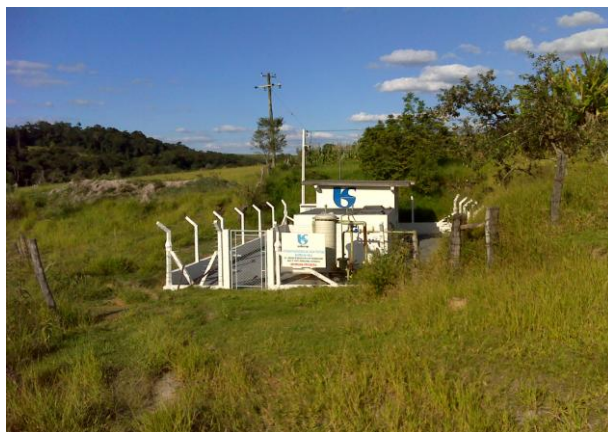
FOTO 4.16 – ESTAÇÃO ELEVATÓRIA DE ÁGUA TRATADA DO BAIRRO DA ONÇA
