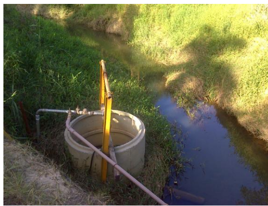
FOTO 4.22 – DETALHE DO POÇO DE SUCÇÃO DO CÓRREGO DO ANGICO
