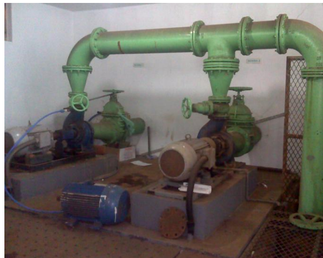
FOTO 4.10 - DETALHE DA EEAT 2 DO CENTRO DE RESERVAÇÃO
