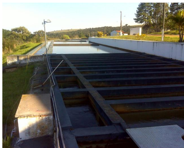
FOTO 4.5 - VISTA DO FLOCULADOR DA ETA DE ITARARÉ
