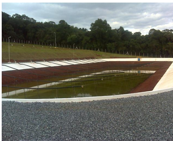
FOTO 4.32 – VISTA DA LAGOA AERADA DA ETE DE ITARARÉ
