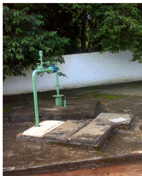
FOTO 4.19 – DETALHE DO POÇO PPS-01 DO BAIRRO DO CERRADO
