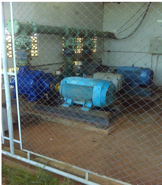
FOTO 4.9 – DETALHE DA EEAT DA ETA ITARARÉ
