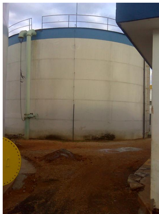
FOTO 4.16 - RESERVATÓRIO R4 NO CENTRO DE RESERVAÇÃO DE ITARARÉ
