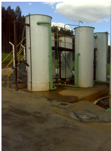
Foto 4.23 – Vista da ETA de Santa Cruz dos Lopes
