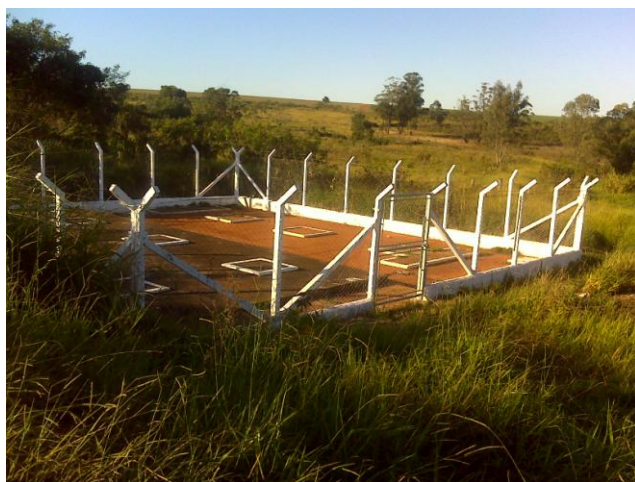
FOTO 4.37 – VISTA DA ETE FOSSA FILTRO DA PAULICÉIA
