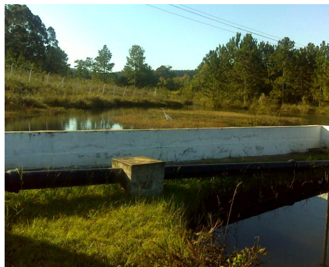
FOTO 4.3 - VISTA DA ADUTORA DA EEAB – RIO ITARARÉ
