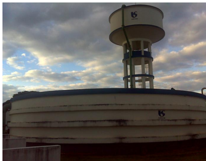
FOTO 4.14 - RESERVATÓRIO R2 NO CENTRO DE RESERVAÇÃO DE ITARARÉ
