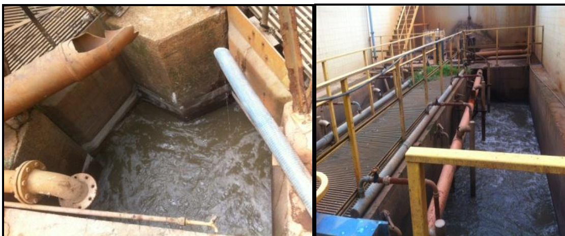
Figura 52 - Caixas de areia
