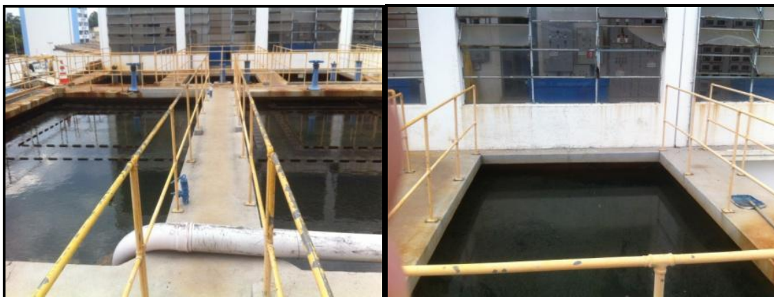
Figura 39 - Decantadores e filtros – Módulo II
