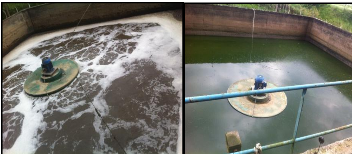
Figura 58 - Tanques de aerção
