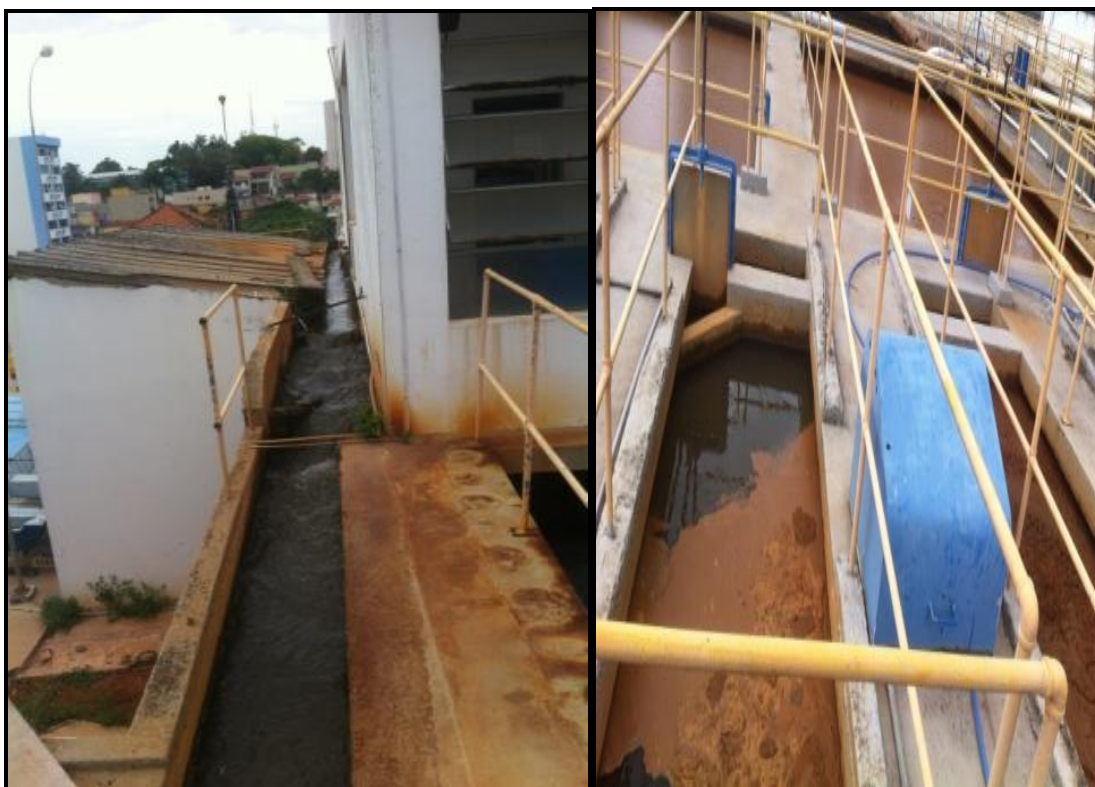
Figura 38 - Chegada água bruta e flocculadores – Módulo II
