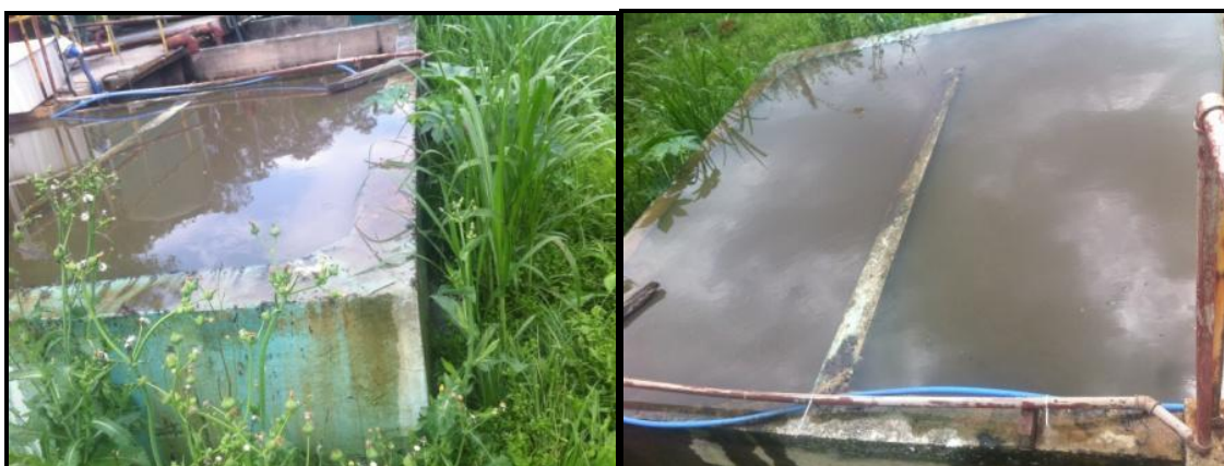
Figura 59 - Tanques de dosagem de cloro
