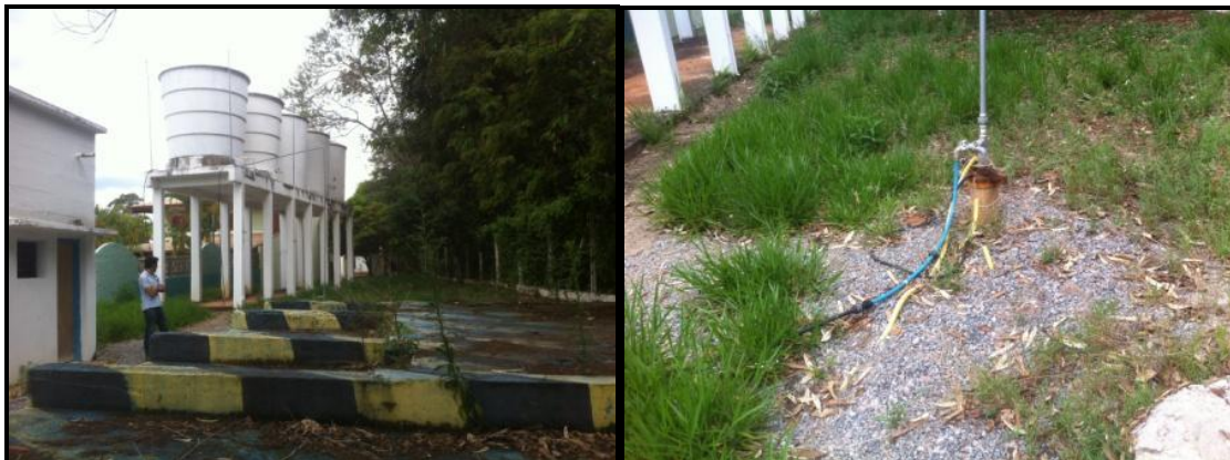
Figura 41 - Poço e reservação
