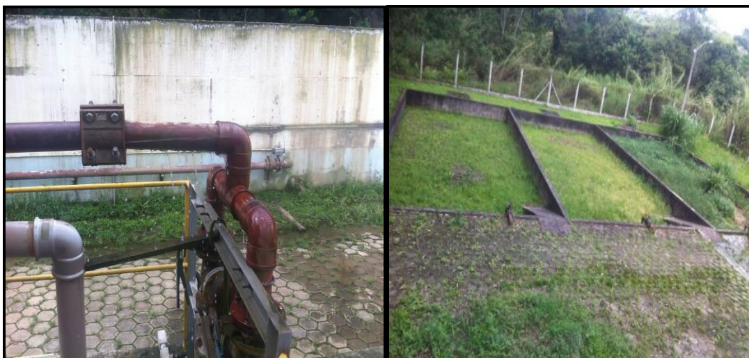
Figura 60 - Dosador de cloro e leito de secagem
