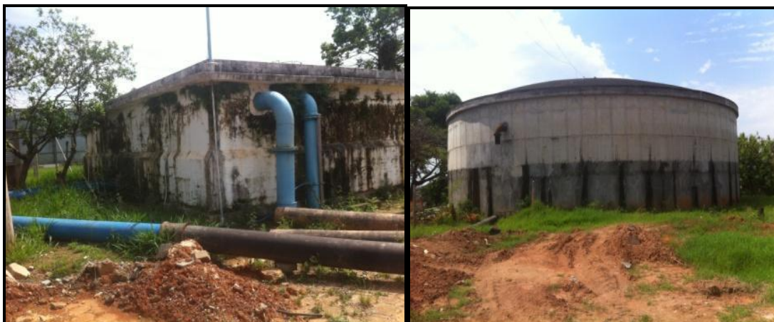
Figura 46 - Centro de reservação Santa Cruz – Reservatórios semi-enterrados
