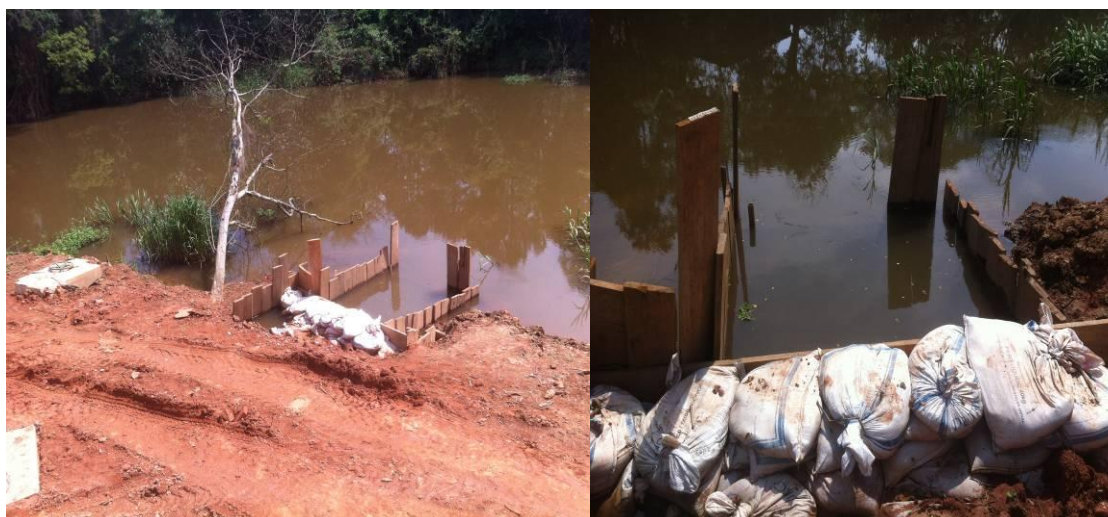
Figura 31 - Canal de tomada
