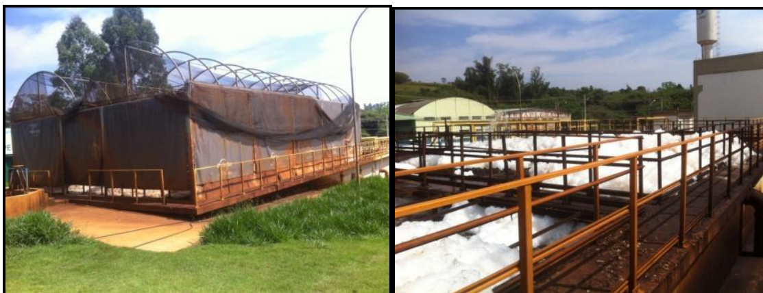
Figura 55 - Filtros aeróbicos 1 e 2
