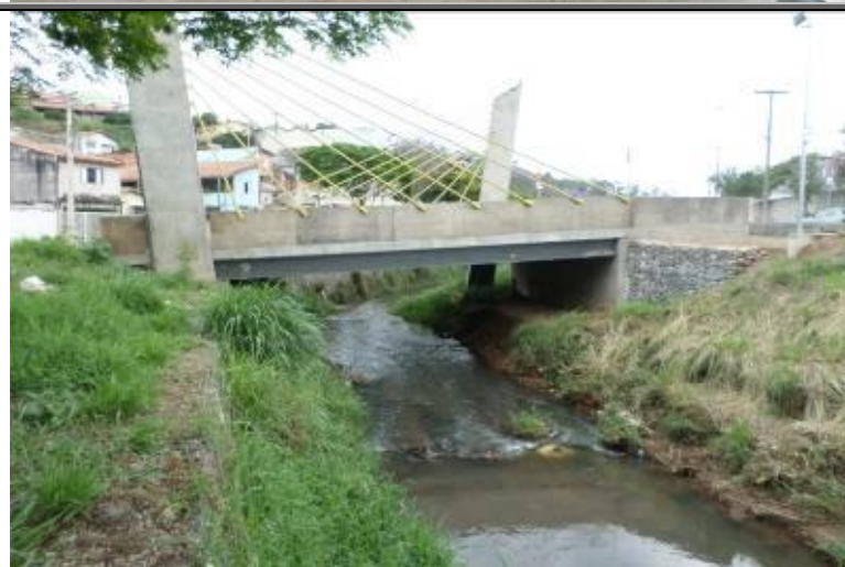
Figura 127 - Vista a montante das condições da ponte da Travessa Olivio Tegen.
