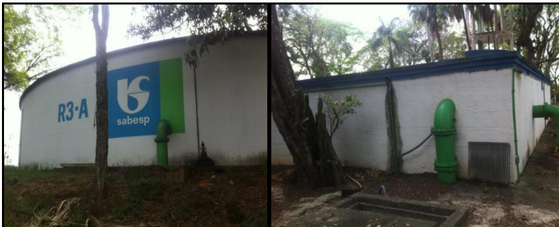
Figura 43 - Centro de reservação Saudade – Reservatórios semi -enterrados
