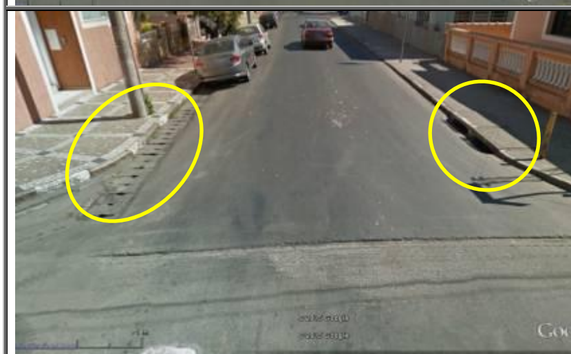
Figura 155 - Vista à direita da imagem, uma Boca de lobo sem grelha e à esquerda
