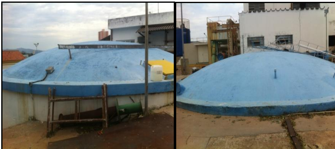
Figura 42 - Reservatórios R1 e R2
