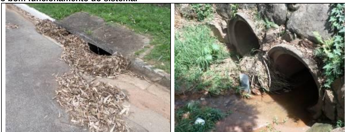
Figura 95 - Exemplo de obstruções nas estruturas de drenagem que comprometem o bom funcionamento do sistema.
