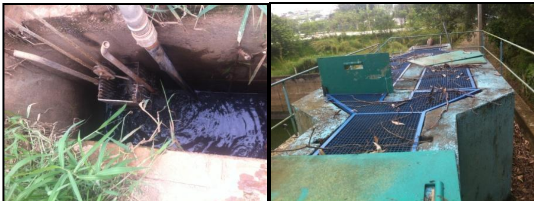
Figura 57 - Chegada do efluente e gradeamento
