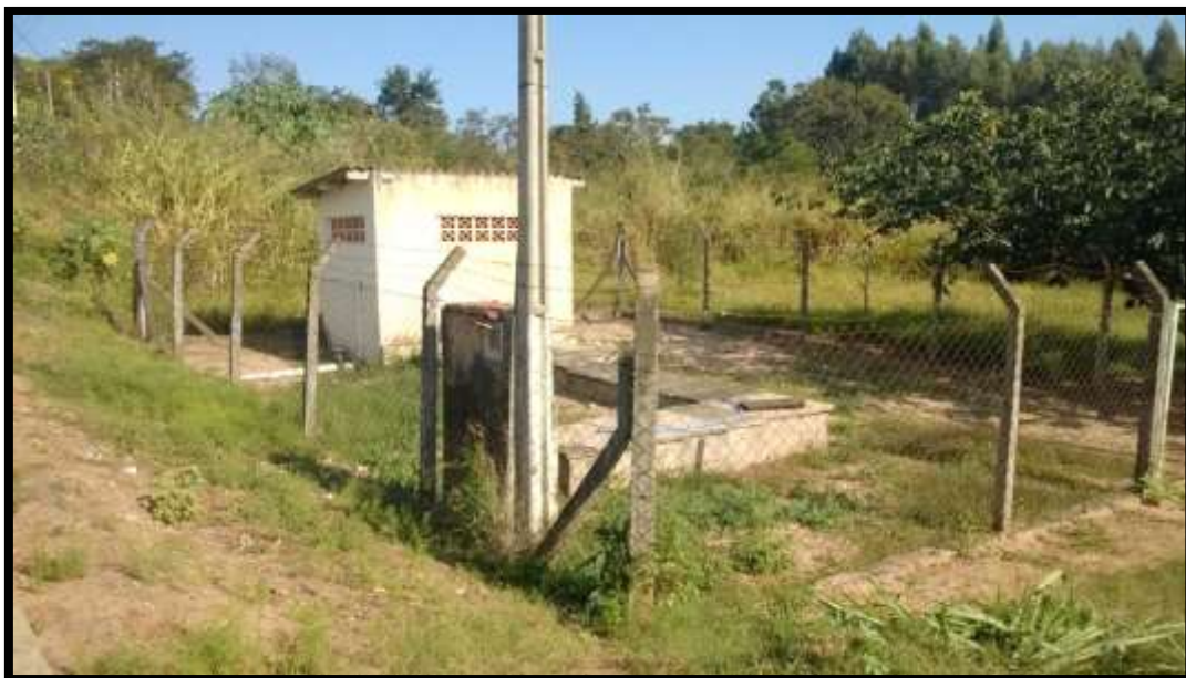
Figura 31 - Estação Elevatória de Esgoto 01 - Jardim Lemos
