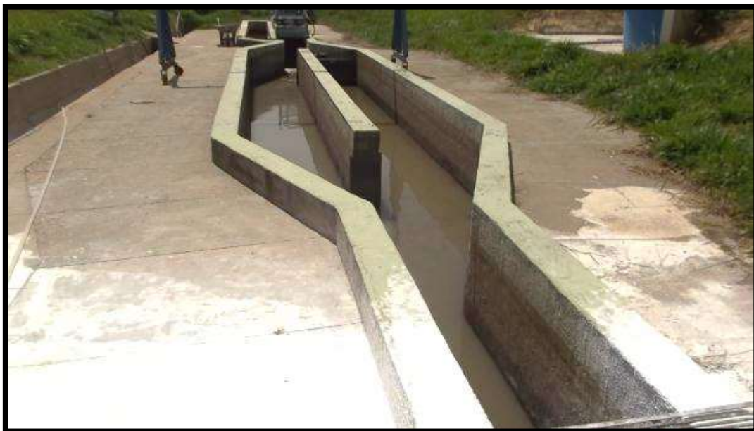
Figura 23 - Tratamentos Preliminares na ETE
