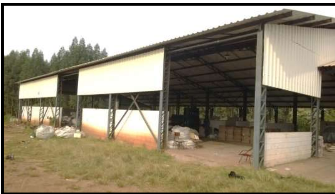
Figura 48 - Centro de Triagem Operado pela COOPEREI
