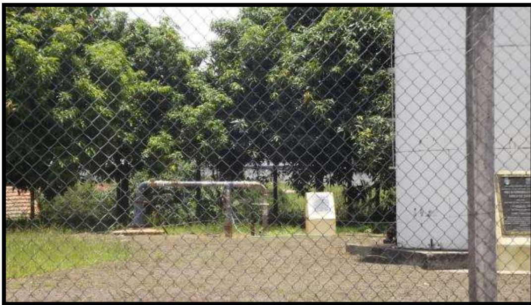
Figura 5 - Poço 02 e Reservatório 4 – Rua 5- Vila Garbi
