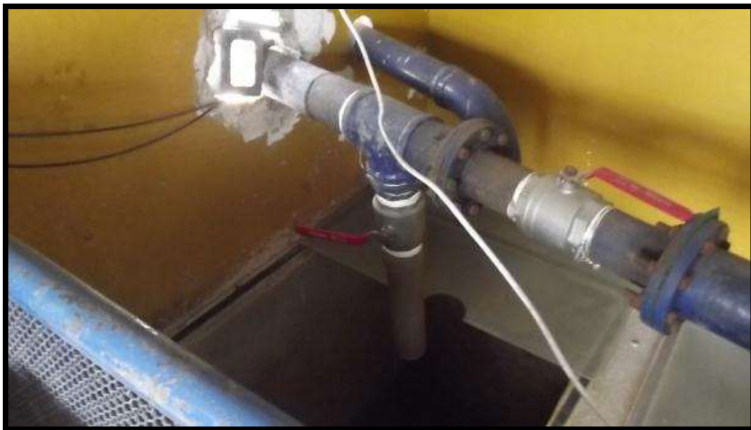
Figura 11 - Decantador do Poço 09, Reservatório 02
