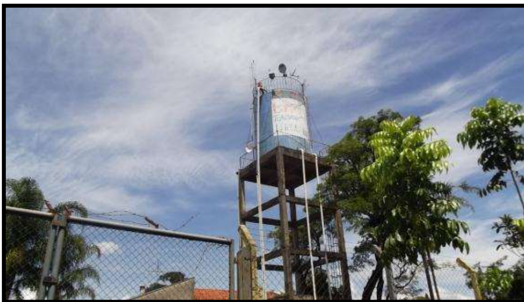
Figura 16 - Reservatório 6 - Rua 13, Balneário Santo Antônio
