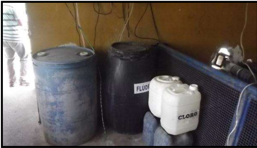
Figura 12 - Dosagem de Cloro e Flúor Poço 09, Reservatório 02
