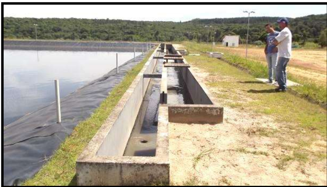
Figura 25 - Canaleta de distribuição da Lagoa Anaeróbia
