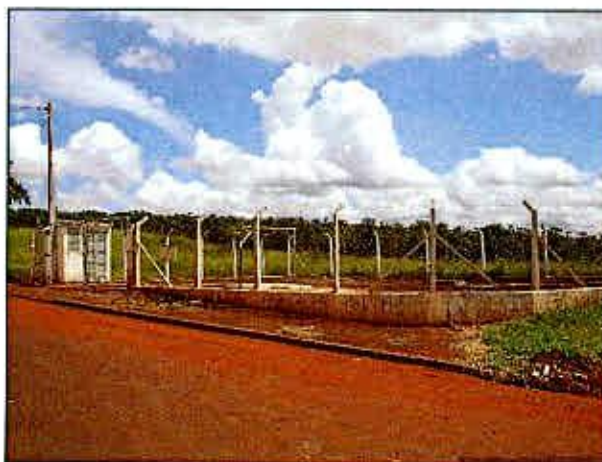
Foto 7 - Estação Elevatória 01 (EEE01)
