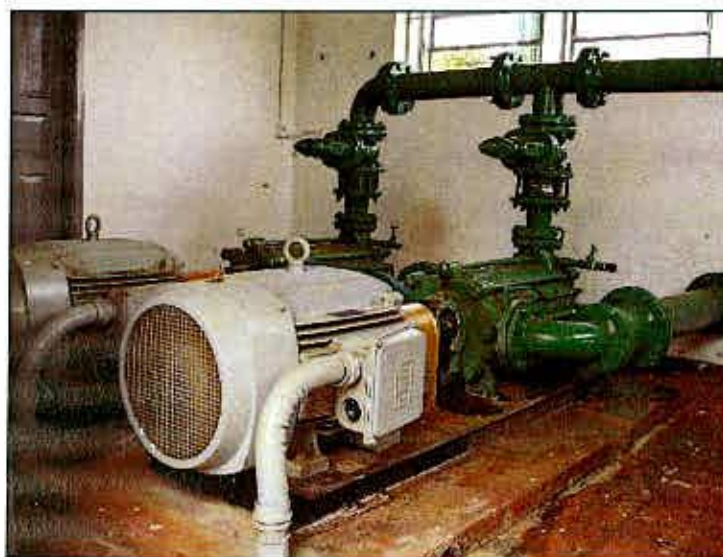
Foto 4 - Vista interna - equipamentos da EEAT 01
