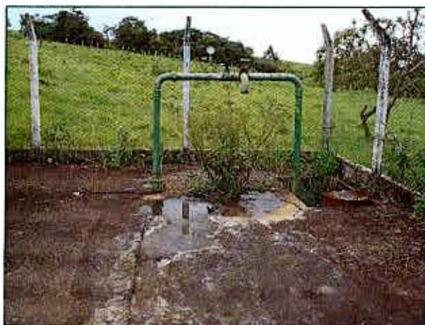
Foto 2 - Poço PPS03 (fora de operação)
