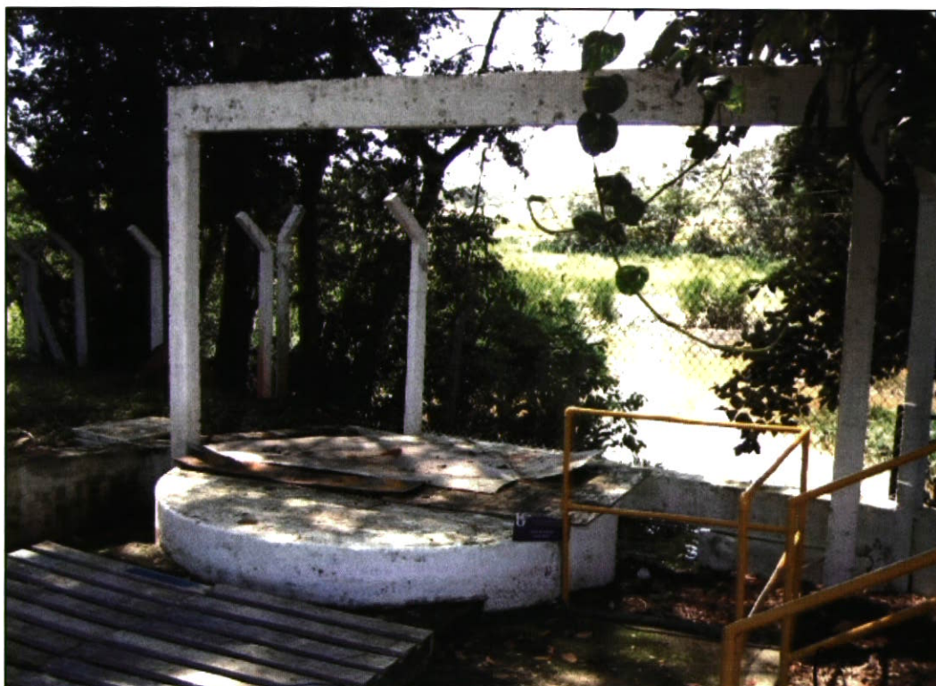
Foto 3 - Estação elevatória de água bruta EEAB01, equipada com bombas submersíveis, localizada junto ao Rio Doce
