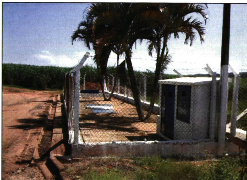
Foto 14 - Vista da estação elevatória de esgotos da sub-bacia Nova Itobi EEE-01, responsável pela reversão dos esgotos para a sub-bacia Centro
