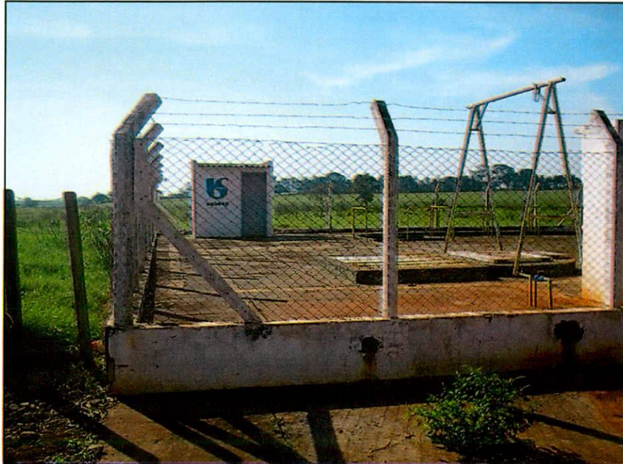
Foto 10 - Estação elevatória de esgotos (EEE 01)
