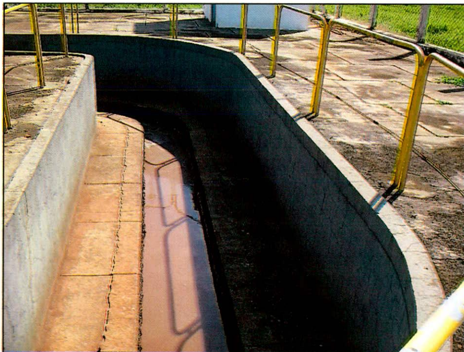
Foto 11 - Caixa de areia da EEE 01
