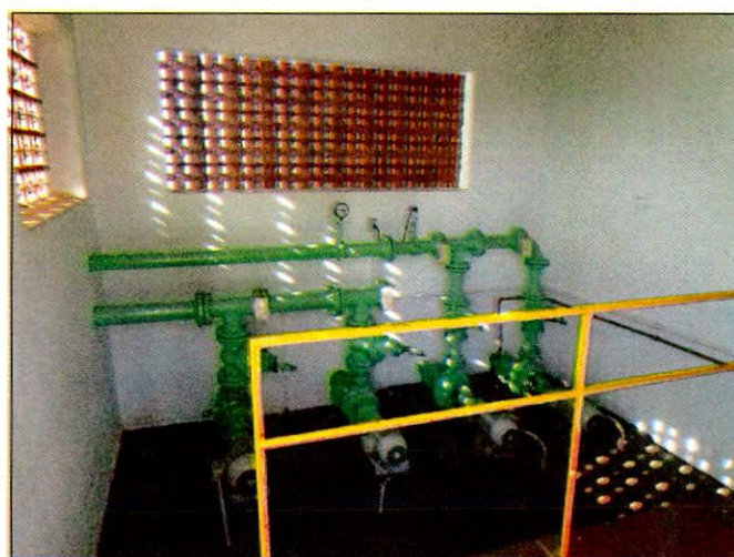
Foto 8 - Vista interna - Equipamentos da EEAT 01 e do Booster 01
