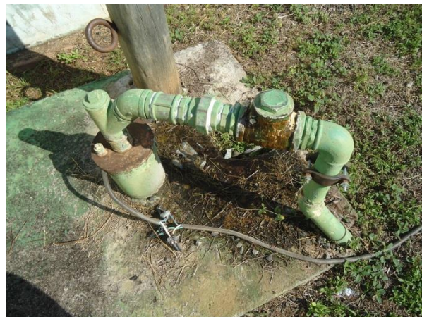
Foto 3.2 – Poço 01B – Dep. De Educação
