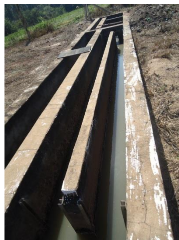
Foto 3.38 – Tratamento Preliminar – Caixa de Areia
