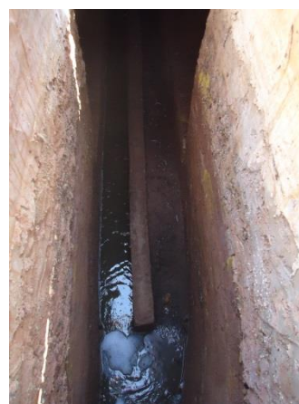
Foto 3.28 – Caixa de areia –EEE Praça
