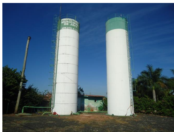
Foto 3.7 – Reservatórios apoiados metálicos
