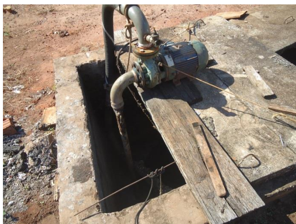
Foto 3.26 – Detalhe – Poço de sucção e instalação da bomba
