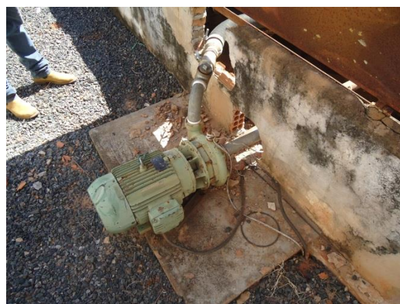
Foto 3.30 – Detalhe instalação do conjunto motobomba –EEE Praça
