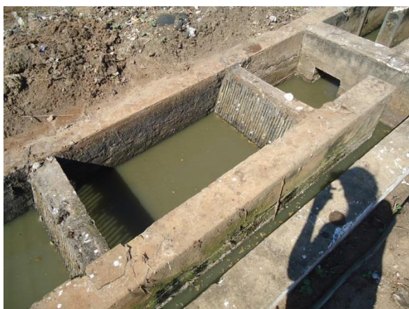
Foto 3.37 – Tratamento Preliminar - Gradeamento
