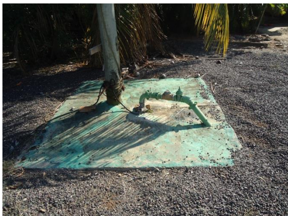
Foto 3.1 – Poço 01A - Anízio
