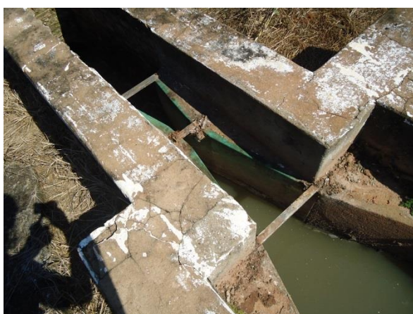
Foto 3.39 – Tratamento Preliminar – Calha Parshall
