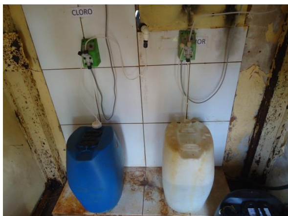
Foto 3.21 – Bombas dosadoras de cloro e flúor
