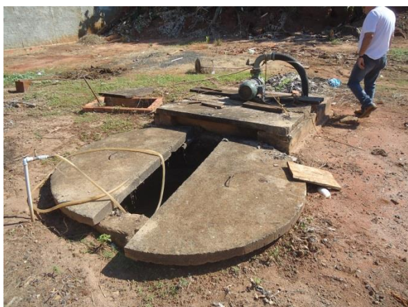
Foto 3.24 – Vista Geral –Poço de Sucção e Poço Pulmão – EEE São Benedito
