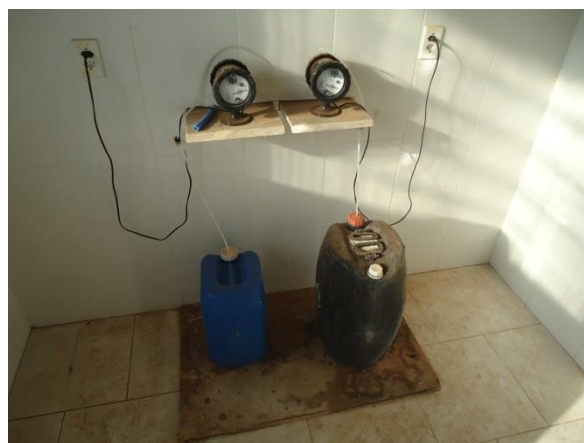
Foto 3.22 – Bombas dosadoras de cloro e flúor
