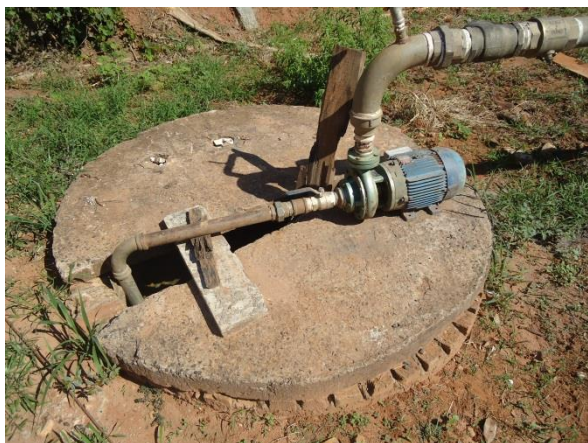
Foto 3.31 – Poço de Sucção – Zé Barbosa
