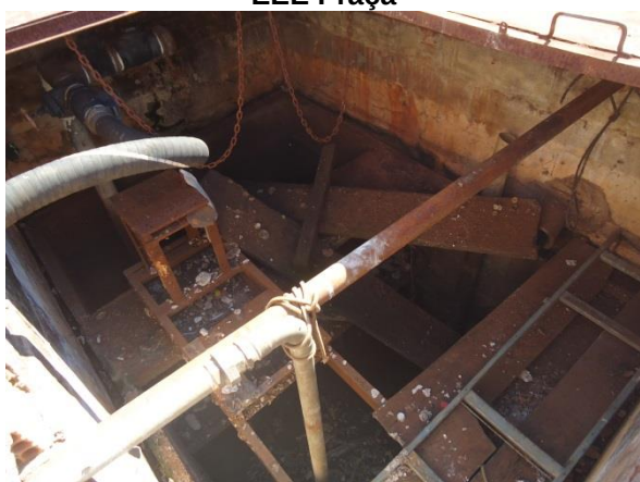
Foto 3.29 – Poço de sucção – EEE Praça
