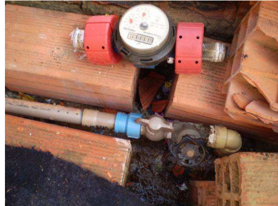
Figura 34. Cavalete sem Hidrômetro.
