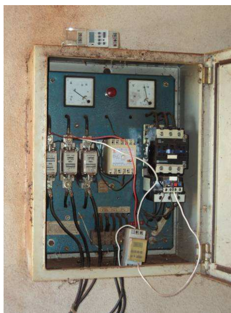
Figura 81. Vista do painel elétrico do Poço P18.
