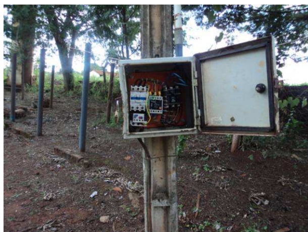
Figura 74. Vista do painel elétrico do Poço P15.
