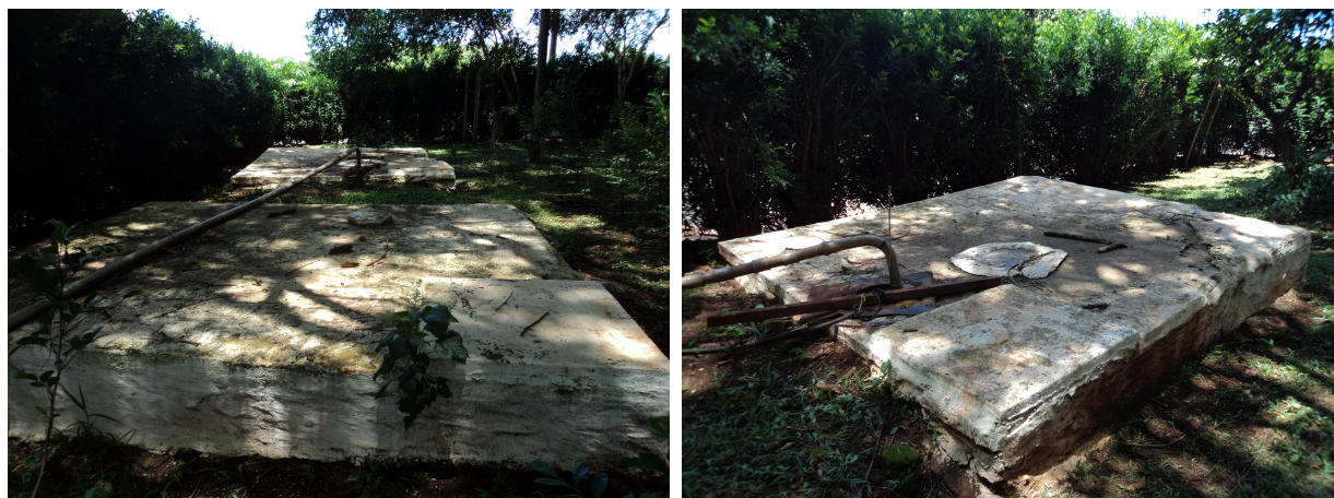
Figura 106. Vista da elevatória de esgoto Rafael Cantoni.
