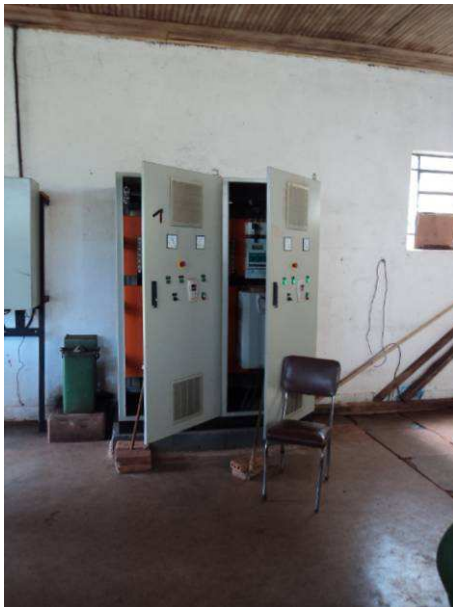
Figura 23. Vista dos painéis elétricos dos conjuntos motor-bombas.
