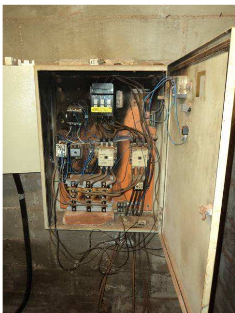
Figura 69. Vista do painel elétrico do Poço P14.
