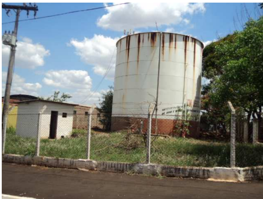
Figura 54. Vista do Poço P10 que abastece o reservatório R6.
