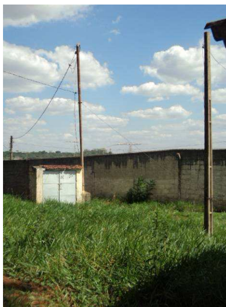
Figura 38. Vista da entrada de energia do Poço P5.
