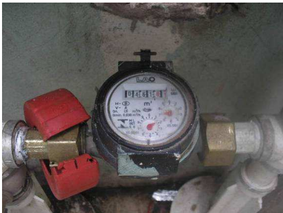
Figura 41. Hidrômetro com lacre violado.
