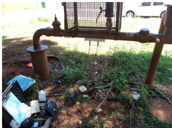
Figura 25. Medição no Poço Área Industrial Adib Rassi (P18).
