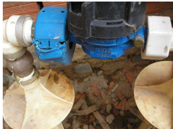
Figura 42. Hidrômetro com lacre violado.
