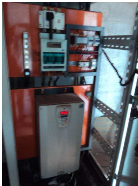
Figura 77. Vista do inversor de frequência existente no Poço P16.
