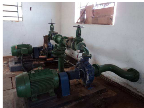
Figura 22. Vista dos dois conjuntos motor-bombas do recalque do R1.
