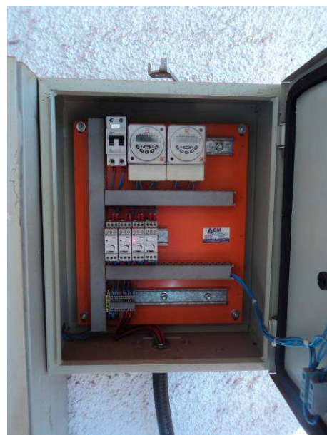
Figura 85. Vista do painel elétrico do Poço P19.
