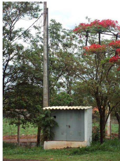
Figura 34. Vista da entrada de energia do Poço P3.
