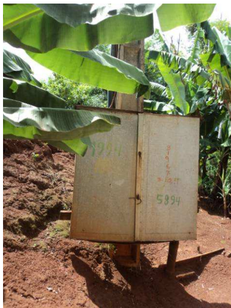
Figura 27. Vista do relógio de energia do Poço P1.
