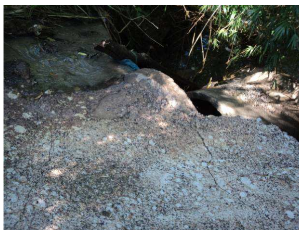
Figura 122. Lançamento de água pluvial próximo ao bairro Bandeirante.
