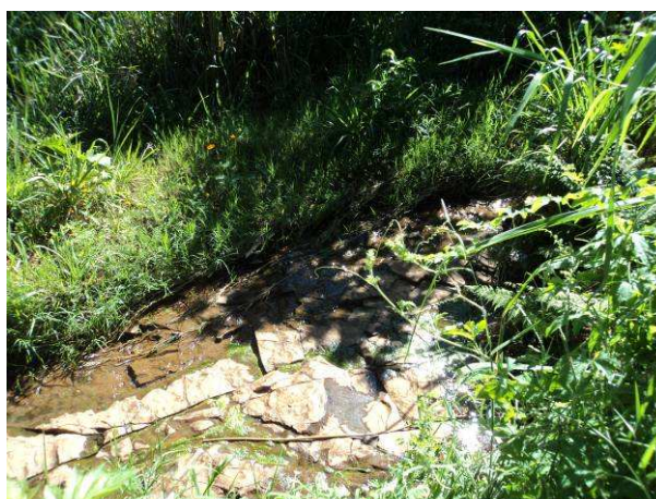
Figura 121. Lançamento de água pluvial no Bosque Municipal.
