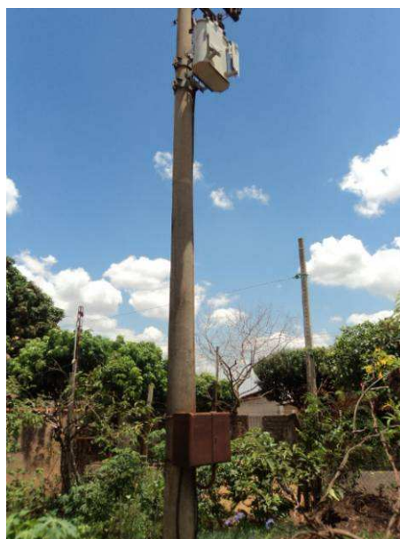
Figura 62. Vista do transformador e do relógio de energia existente no Poço P12.
