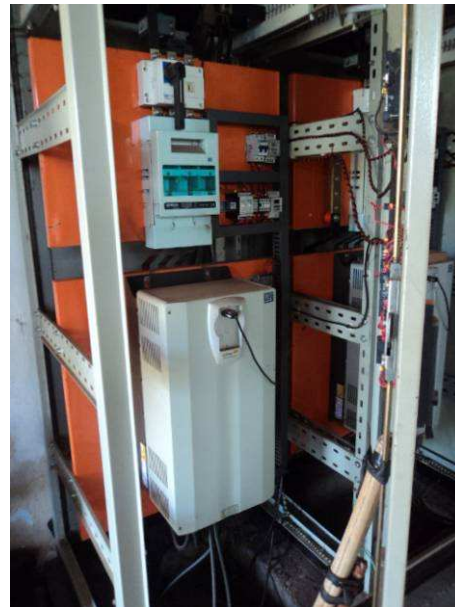
Figura 24. Vista do Inversor de frequência existente para os conjuntos motor-bombas.
