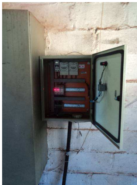
Figura 42. Vista do painel elétrico do booster existente na saída do R10.
