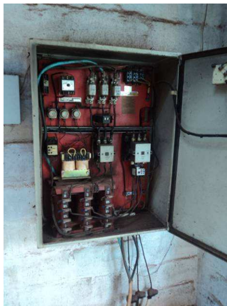
Figura 59. Vista do painel elétrico do Poço P11..
