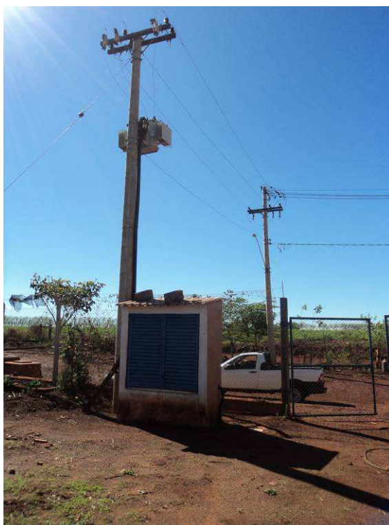
Figura 86. Vista do transformador existente no Poço P19.
