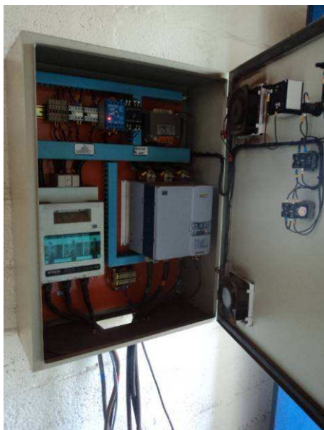
Figura 65. Vista do painel elétrico do Poço P13.
