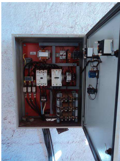
Figura 84. Vista do painel elétrico do Poço P19.
