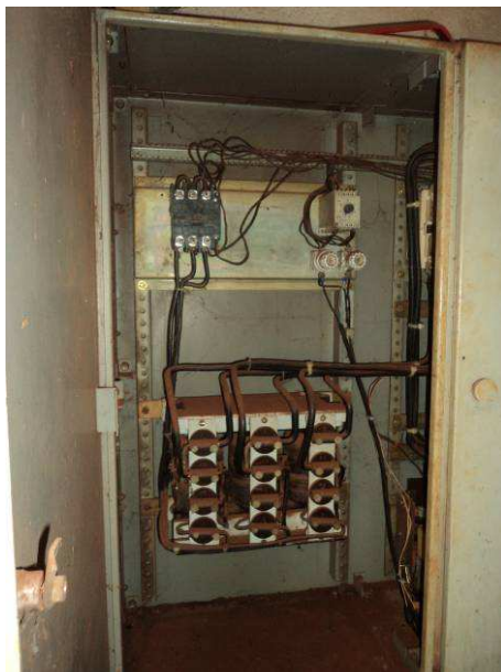
Figura 33. Vista do painel elétrico do Poço P3.
