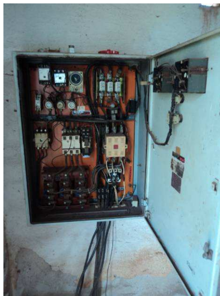
Figura 36. Vista do painel elétrico do Poço P4.
