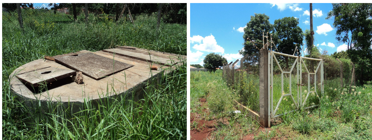
Figura 105. Vista da elevatória de esgoto César Carpato.
