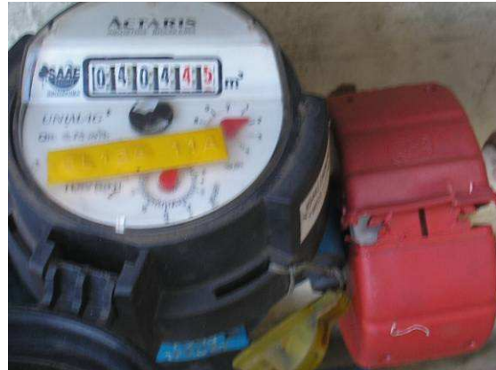
Figura 40. Hidrômetro com lacre violado.
