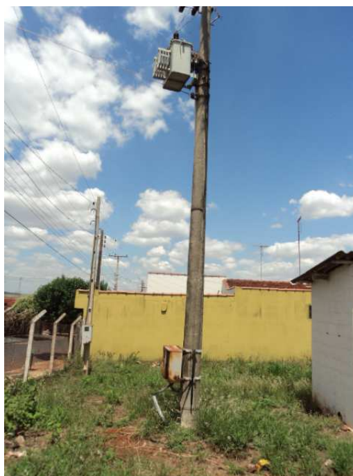
Figura 57. Vista do transformador existente no Poço P10.
