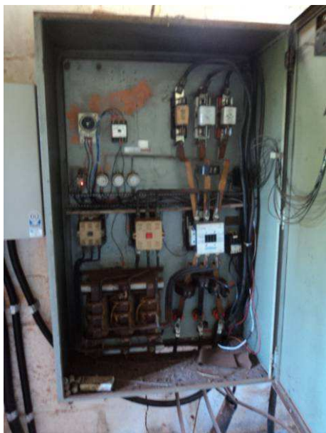
Figura 41. Vista do painel elétrico do Poço P6.
