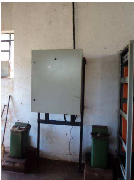
Figura 25. Vista do painel elétrico do Poço P1.
