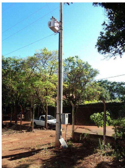
Figura 71. Vista do transformador existente no Poço P14.
