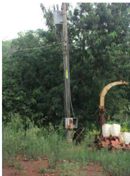
Figura 75. Vista do transformador existente no Poço P15.
