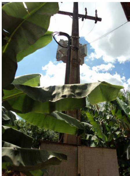
Figura 28. Vista do transformador existente no Poço P1.
