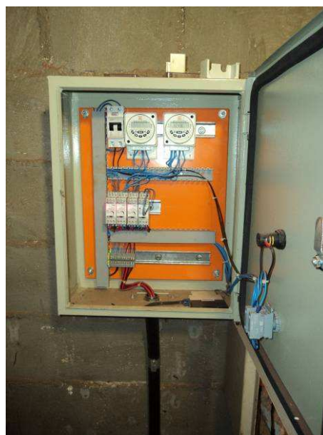
Figura 70. Vista do painel elétrico do Poço P14.
