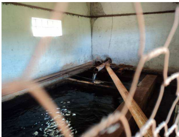
Figura 21. Entrada de água no reservatório R1 vinda por gravidade da mina SPR.
