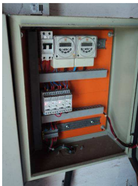
Figura 56. Vista do painel elétrico do Poço P10..
