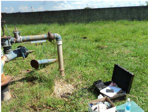
Figura 13. Medição no Poço Centro Esportivo (P5).
