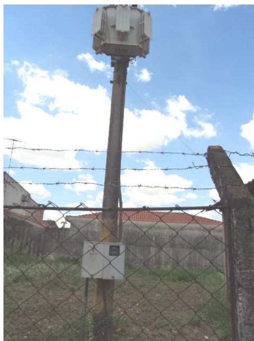
Figura 60. Vista do transformador e do relógio de energia existente no Poço P11.
