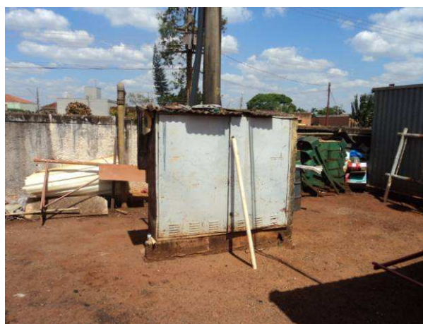
Figura 30. Vista do painel elétrico do Poço P2.
