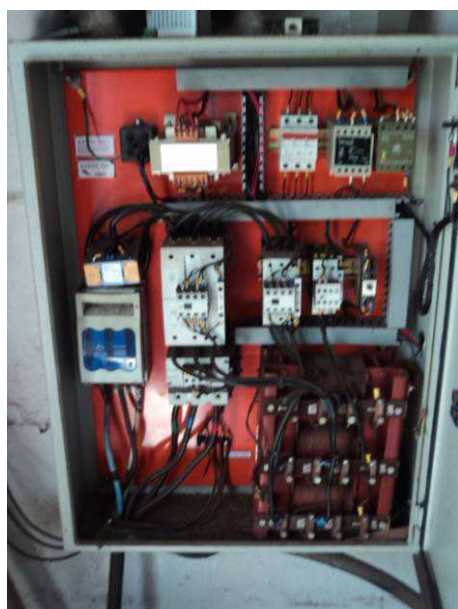
Figura 55. Vista do painel elétrico do Poço P10.
