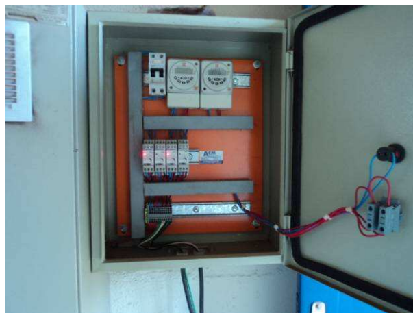
Figura 66. Vista do painel elétrico do Poço P13.
