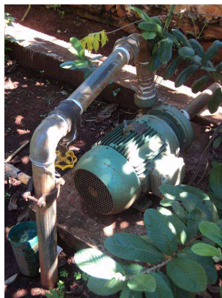
Figura 47. Conjunto motor-bomba existente no recalque do reservatório R4.
