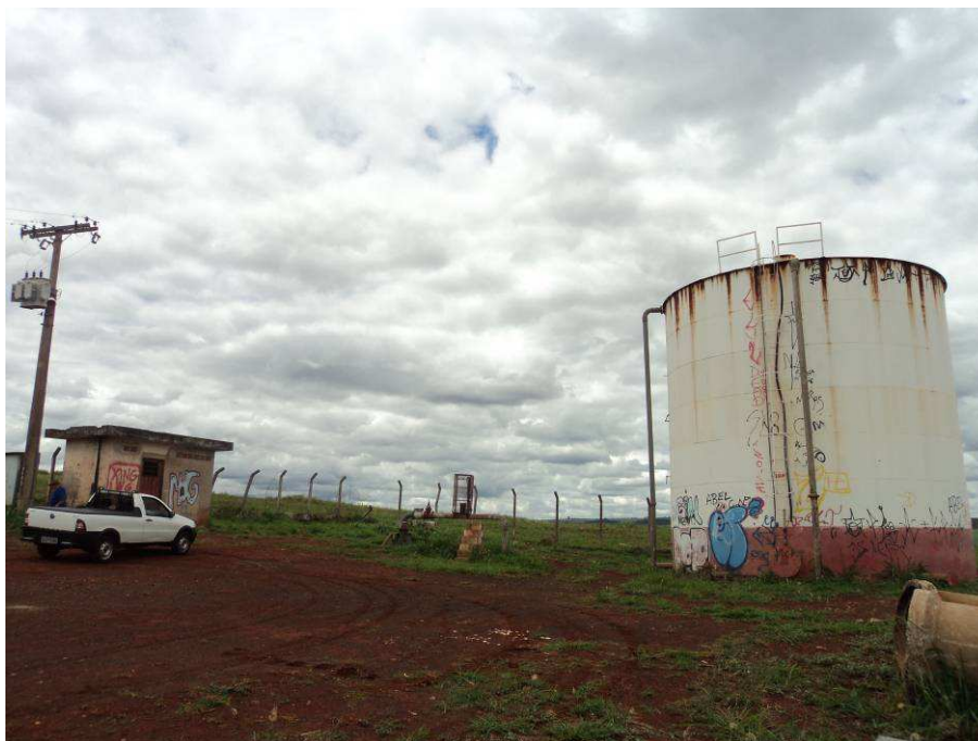
Figura 51. Vista do Poço P9 que abastece o reservatório R5.
