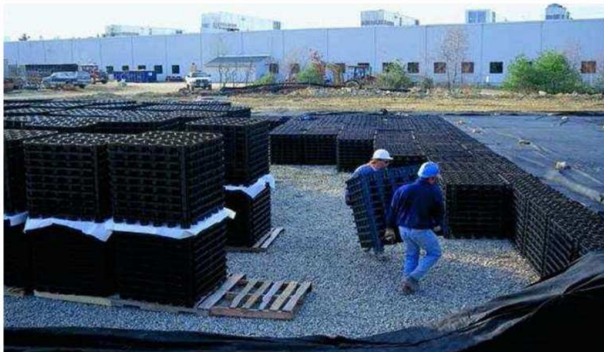
Figura 87. Reservatório de detenção enterrado.
