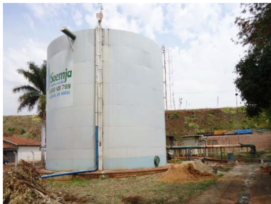
Figura 5.65: Centro de reservação Santo Antônio – RP4.
