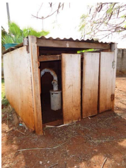
Figura 5.58: Poço de captação P9.
