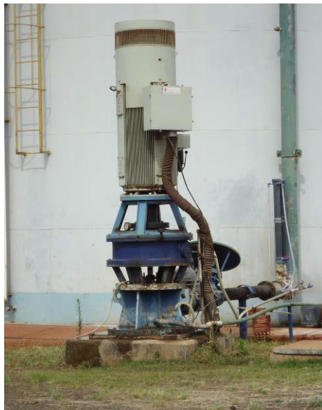
Figura 5.48: RP8 – Poço de captação do Aquífero Guarani.
