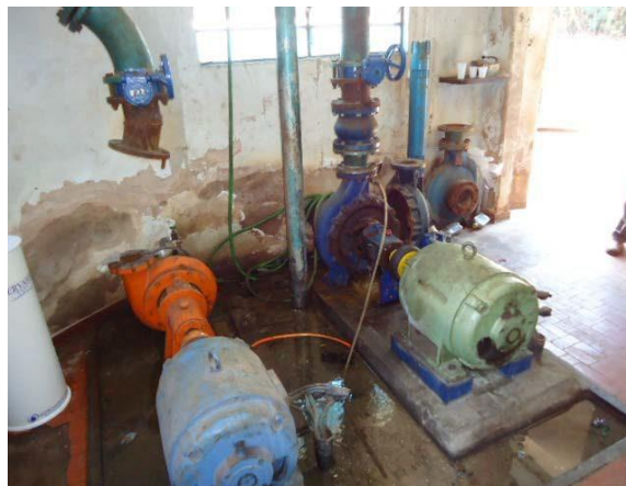
Figura 5.95: Detalhe das Bombas da estação elevatória Fórum.
