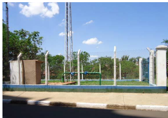
Figura 5.53: Poço de captação P3
