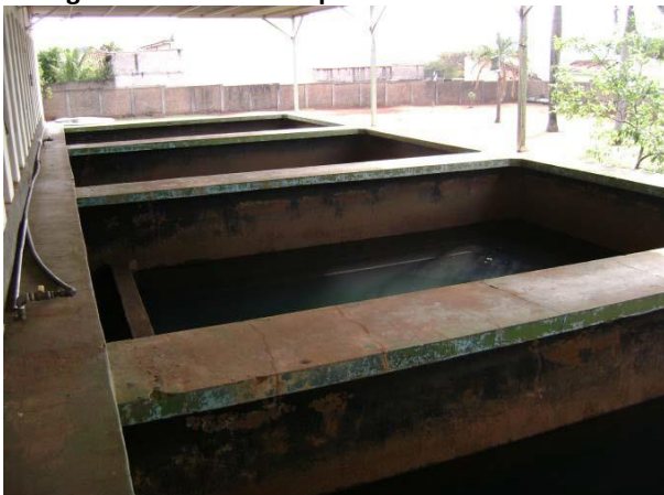
Figura 5.16: Vista dos quatro filtros existentes.
