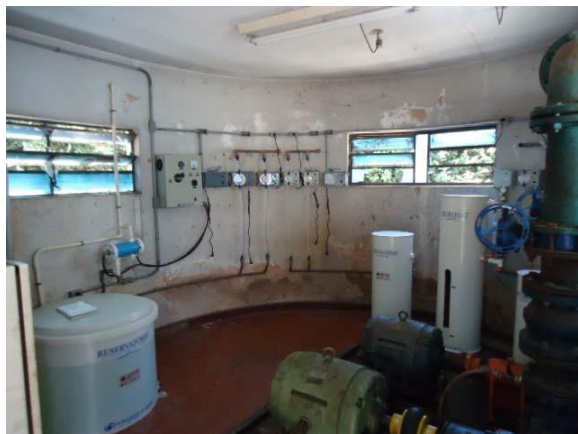
Figura 5.94: Vista das instalações da estação elevatória Fórum.
