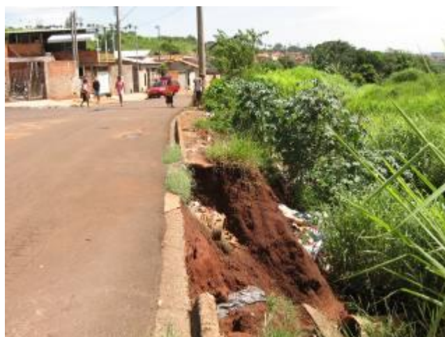
Foto 10 – Desabamento na Rua Paulo Ronchezel
