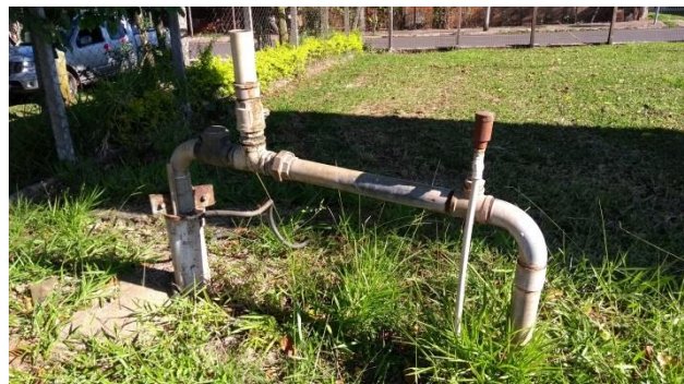
Foto 3.2 - Identificação do Poço P-02
