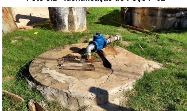
Foto 3.4 - Identificação do Poço P-04
