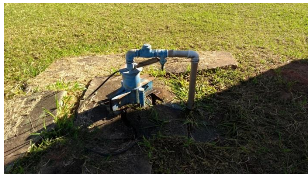
Foto 3.6 - Identificação do Poço P-06
