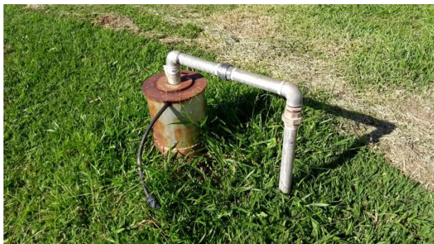
Foto 3.1 - Identificação do Poço P-01
