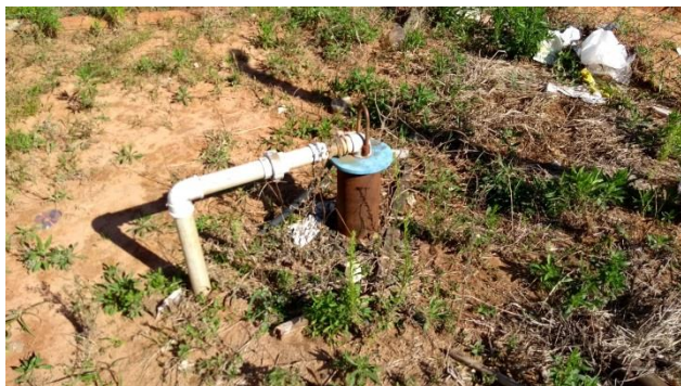
Foto 3.5 - Identificação do Poço P-05
