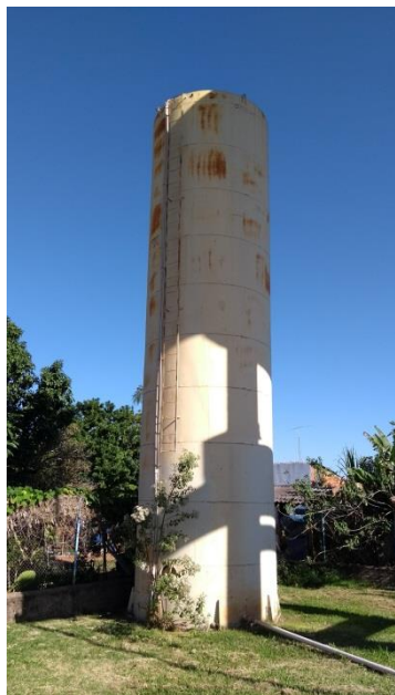
Foto 3.11 - Identificação do reservatório RAP04 em manutenção
