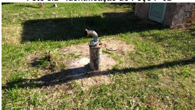
Foto 3.3 - Identificação do Poço P-03 em manutenção
