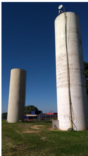
Foto 3.9 - Identificação dos reservatórios REL01 e RAP02
