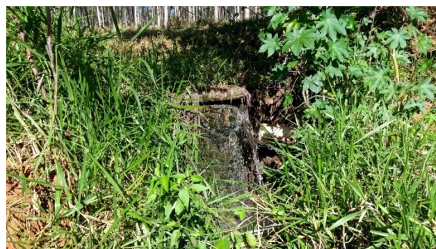
Foto 3.18 – Identificação do vazamento no emissário
