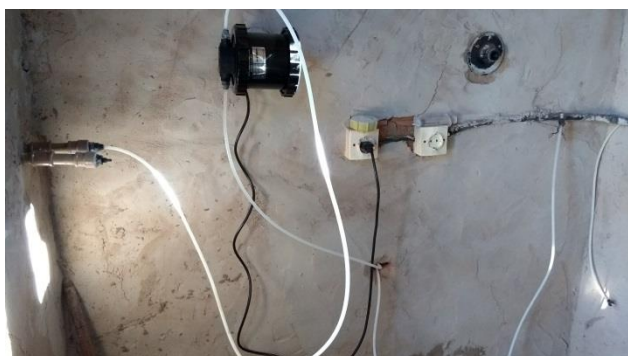
Foto 3.7 - Tratamento da Água
