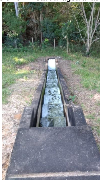
Foto 3.22 – Vista da escada hidráulica
