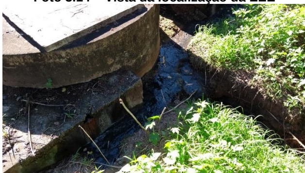
Foto 3.16 – Identificação do vazamento encontrado na EEE
