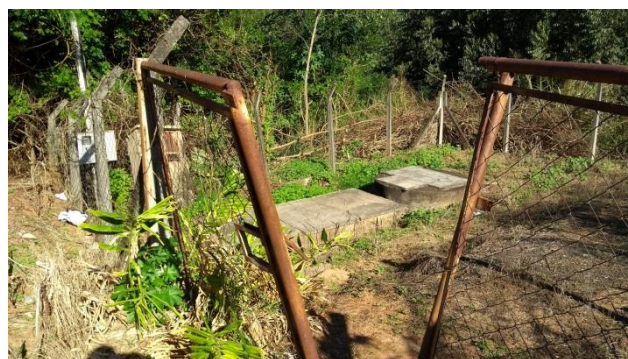
Foto 3.15 – Vista dos elementos da EEE
