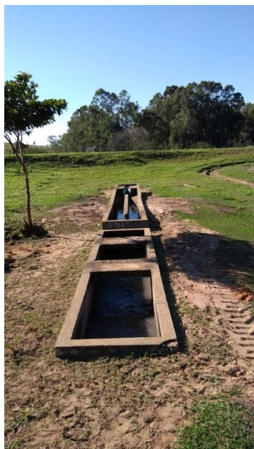
Foto 3.19 – Vista do tratamento preliminar
