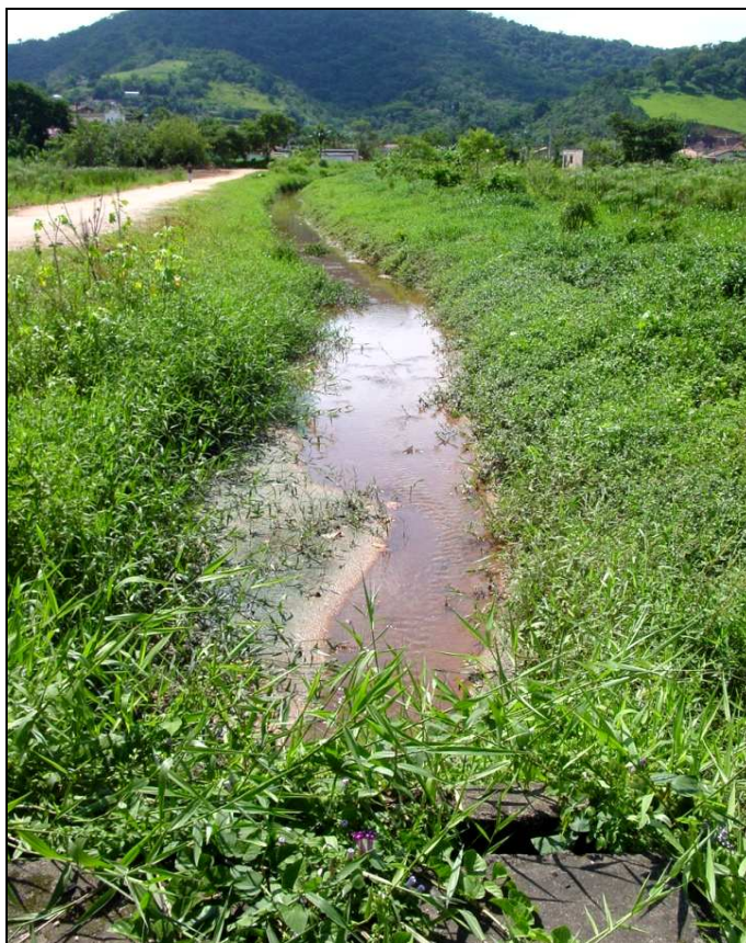
Foto 2 – Área Crítica 2 – Visão do Canal Paralelo à Rua Santa Catarina, Próximo à Esquina com a Avenida Brasil
