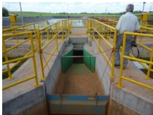
Foto 4.30 – Calha Parshall de Entrada
