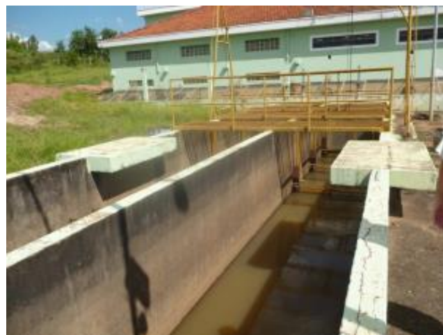
Foto 4.2 – Canal de Derivação para Poço de Sucção da EEAB1
