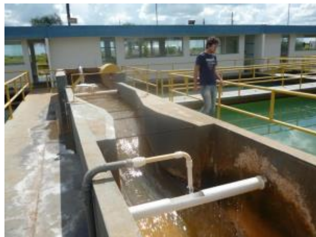
Foto 4.8 – ETA – Calha Parshall
