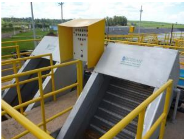
Foto 4.29 – Sistema de Gradeamento
