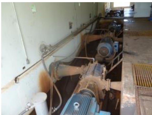
Foto 4.3 – Os Seis Conjuntos-Motobombas Instalados na EEAB1
