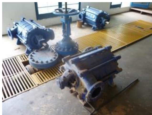
Foto 4.4 – Três das Cinco Bombas Reservas para os Conjuntos em Operação
