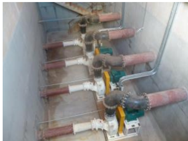
Foto 4.26 – Estação Elevatória de Esgotos Final – Conjuntos Motobomba
