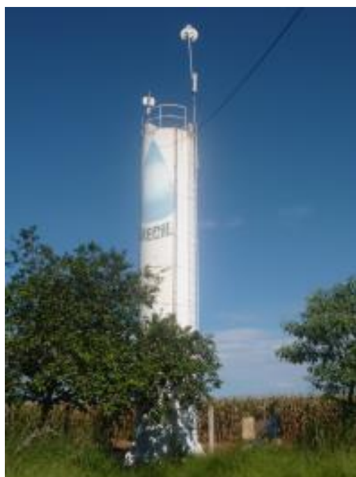
Foto 4.24 – Reservatório R-17 (Bairro do Caju)
