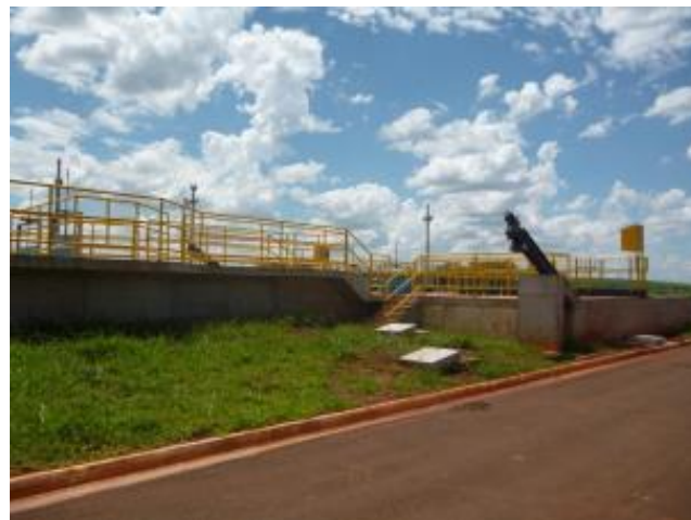
Foto 4.28 – Unidades de Tratamento Preliminar
