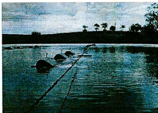
Foto da lagoa de tratamento de esgoto de Lucélia com os aeradores em funcionamento
