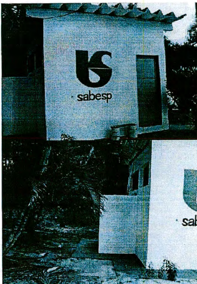
Centro de comando dos aeradores
