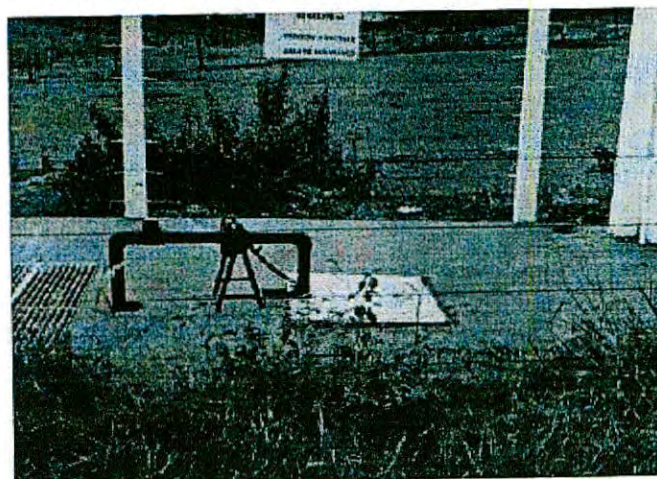
Foto do sistema de entrada da estação elevatória de esgoto nº4
