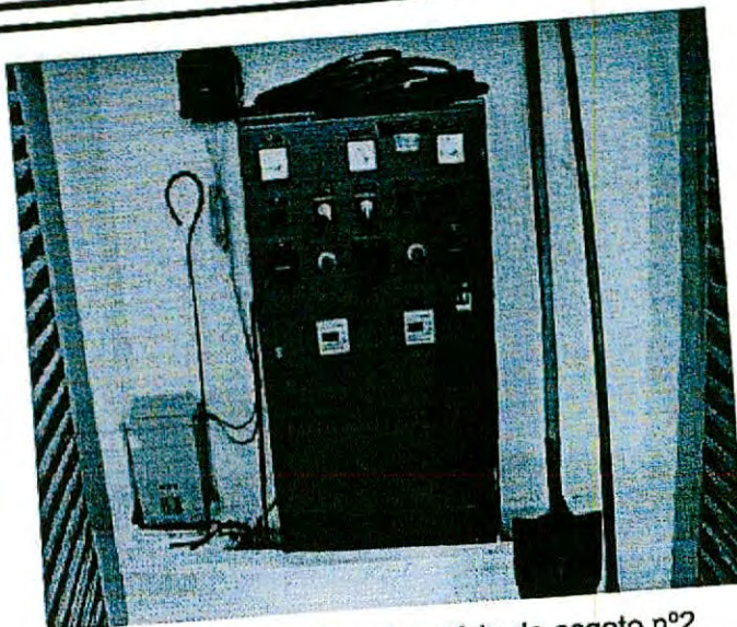
Painel de controle – elevatória de esgoto nº2
