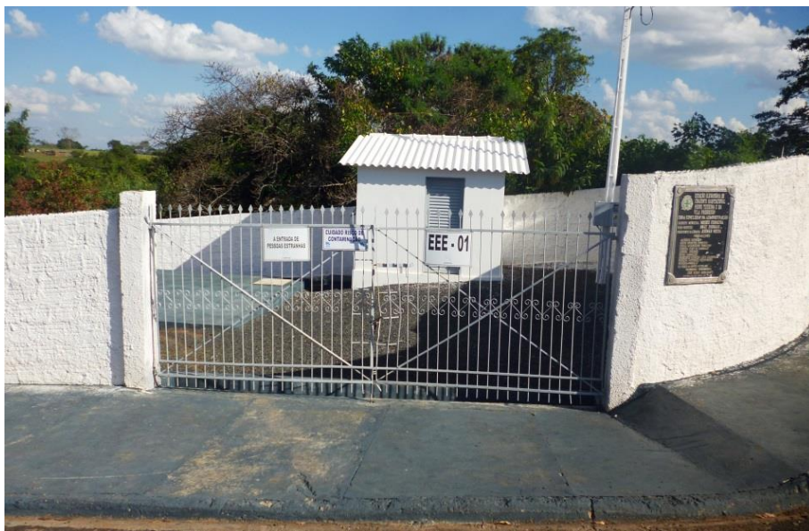
Figura 40. Estação Elevatória de Esgoto 1
