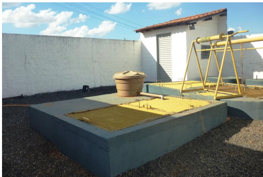
Figura 39. Estação Elevatória de Esgoto 2
