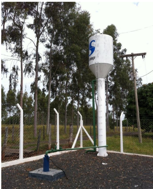
Figura 16. Foto do poço e reservatório 4
