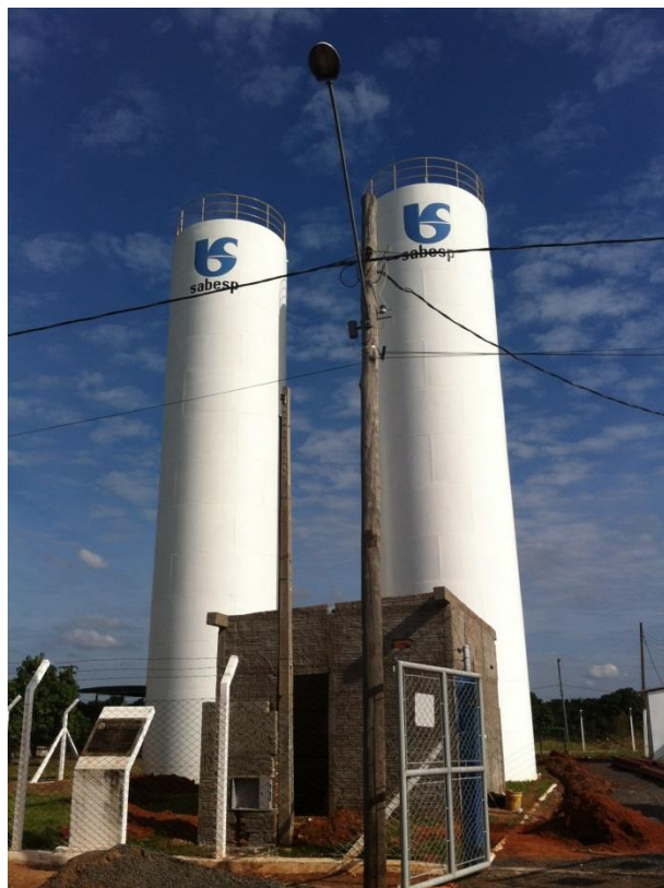
Figura 22. Foto dos reservatórios apoiados, localizados junto ao poço 8
