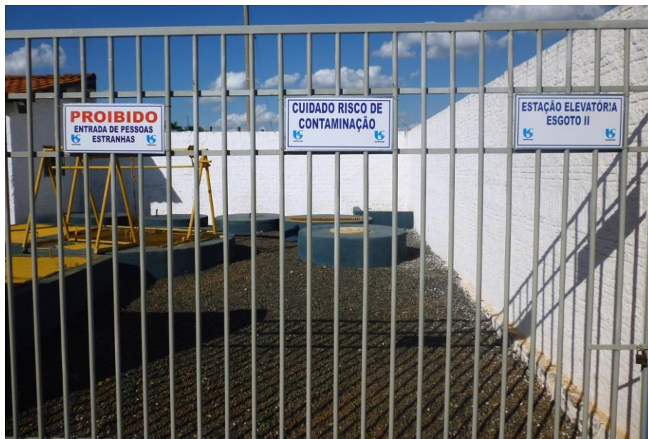
Figura 38. Estação Elevatória de Esgoto 2
