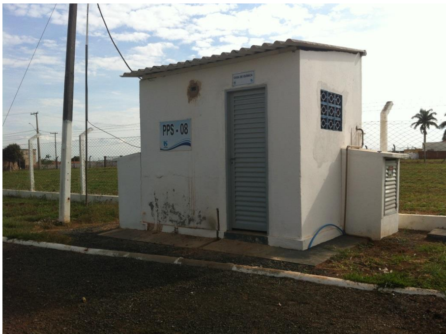
Figura 26. Cloração da água para abastecimento
