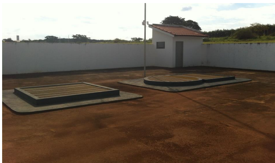
Figura 43. Estação Elevatória de Esgoto 3
