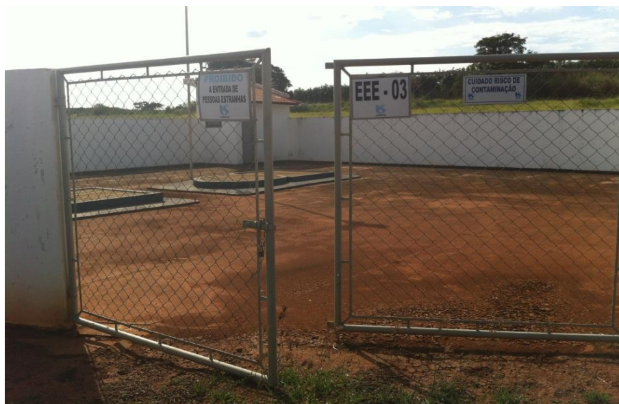
Figura 42. Estação Elevatória de Esgoto 3
