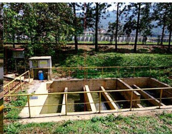
Tanques de contato
