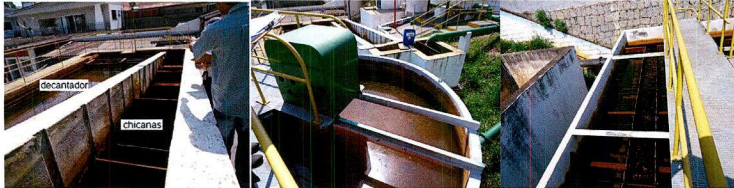
Unidades de floculação e decantação
