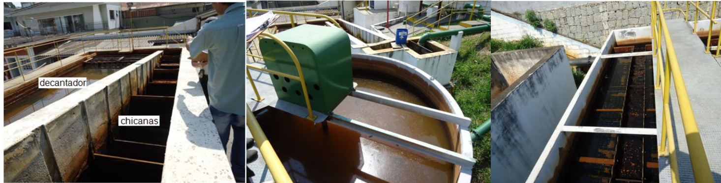
Unidades de floculação e decantação
