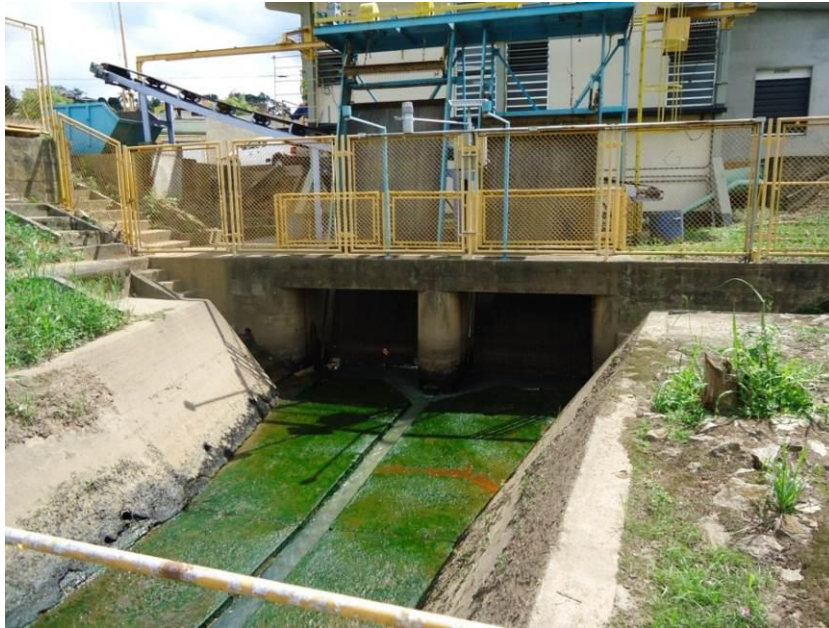
Figura 23 – Estação de bombeamento de águas pluviais. Fonte: SHS, 2011.
