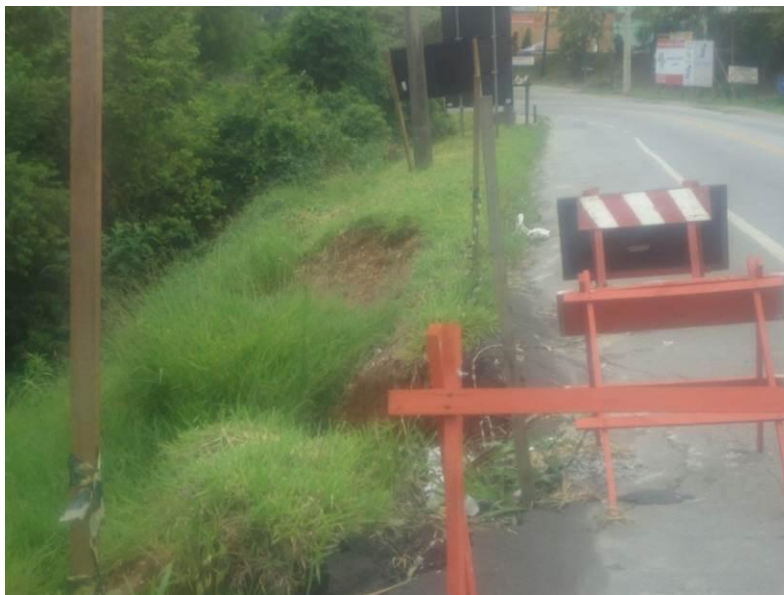
Figura 13 – Ponto de lançamento do escoamento sem dissipadores de energia. Fonte: SHS, 2011.
