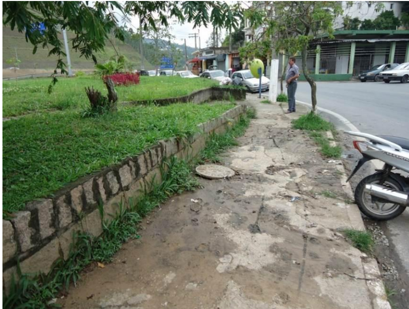
Figura 15 – Ponto de alagamento e interferência com rede de esgotamento sanitário. Fonte: SHS, 2011.
