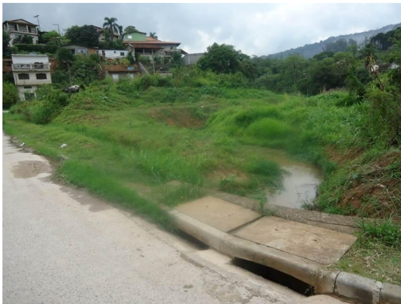
Figura 33 – Ponto de travessia da estrada do Barreiro sobre o córrego sem nome. Fonte: SHS, 2011.
