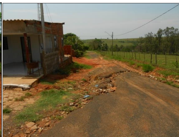
Figura 15– Erosão na Rua Siqueira Campo.
