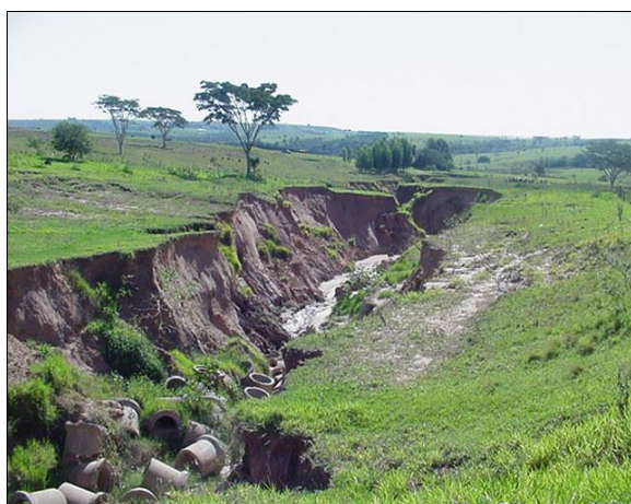
Figura 16– Erosão causada pela ausência de estrutura adequada de dissipação das águas pluviais (final das ruas Acácia e Carlos de Campos).
