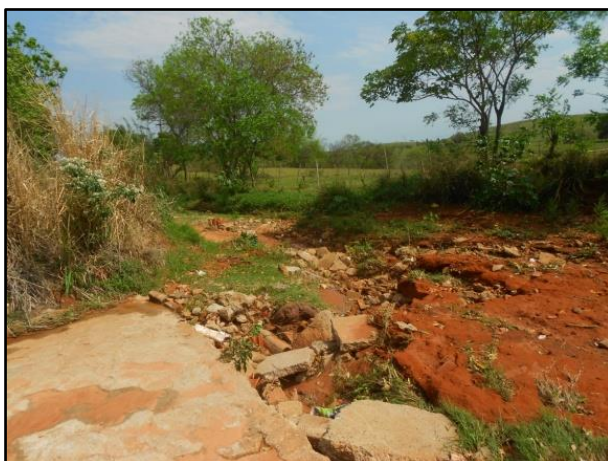
Figura 14– Erosão na Rua da Serraria com a Rua Coronel Marcondes.
