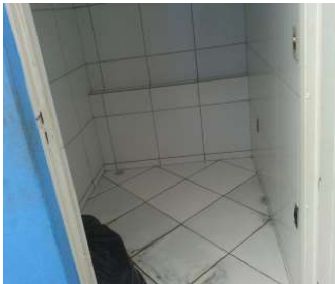
FIGURA 20: Sala de acondicionamento de resíduos de serviços de saúde.
