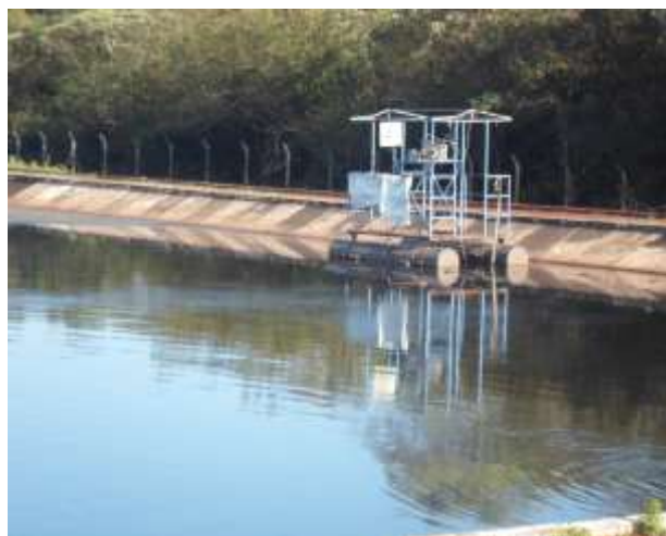
FIGURA 03: Lagoa de tratamento.
