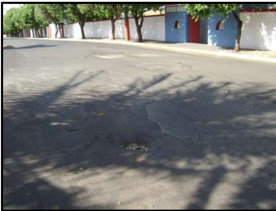
Figura 31 - Vista da Rua 7 de Setembro, mostrando o afundamento do pavimento
