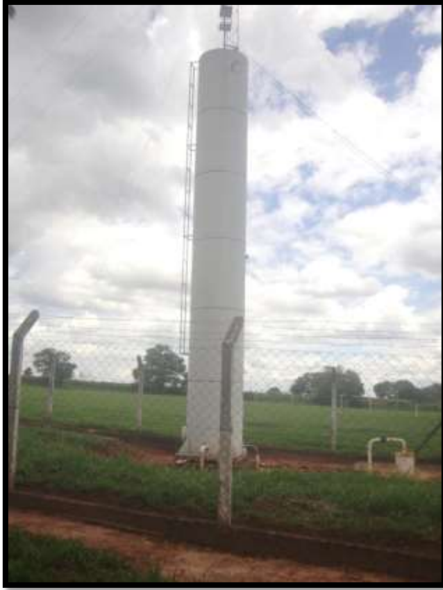
Figura 11 - Reservatório do sistema 4
