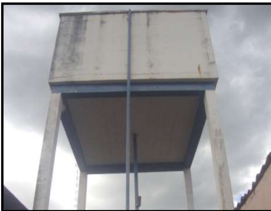
Figura 8 - Reservatório do sistema 1
