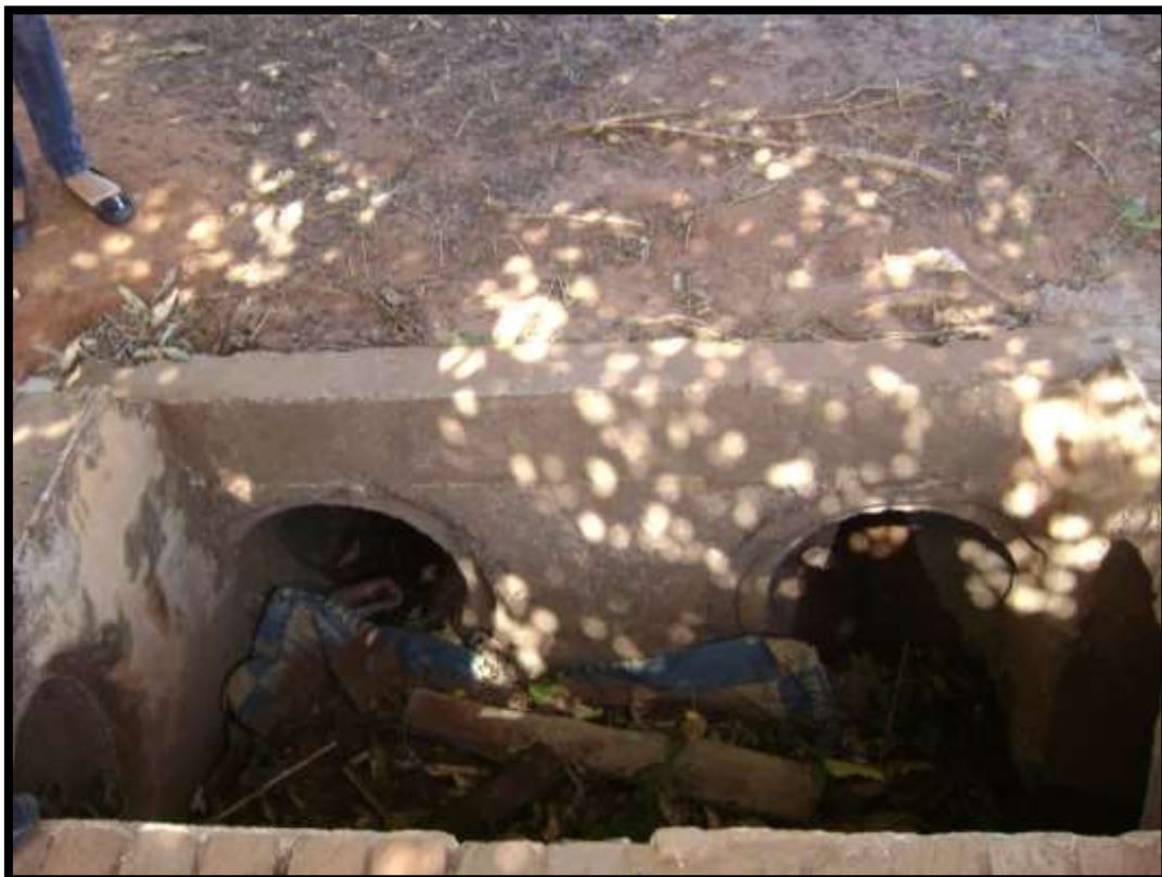
Figura 36 - Caixa de junção existente
