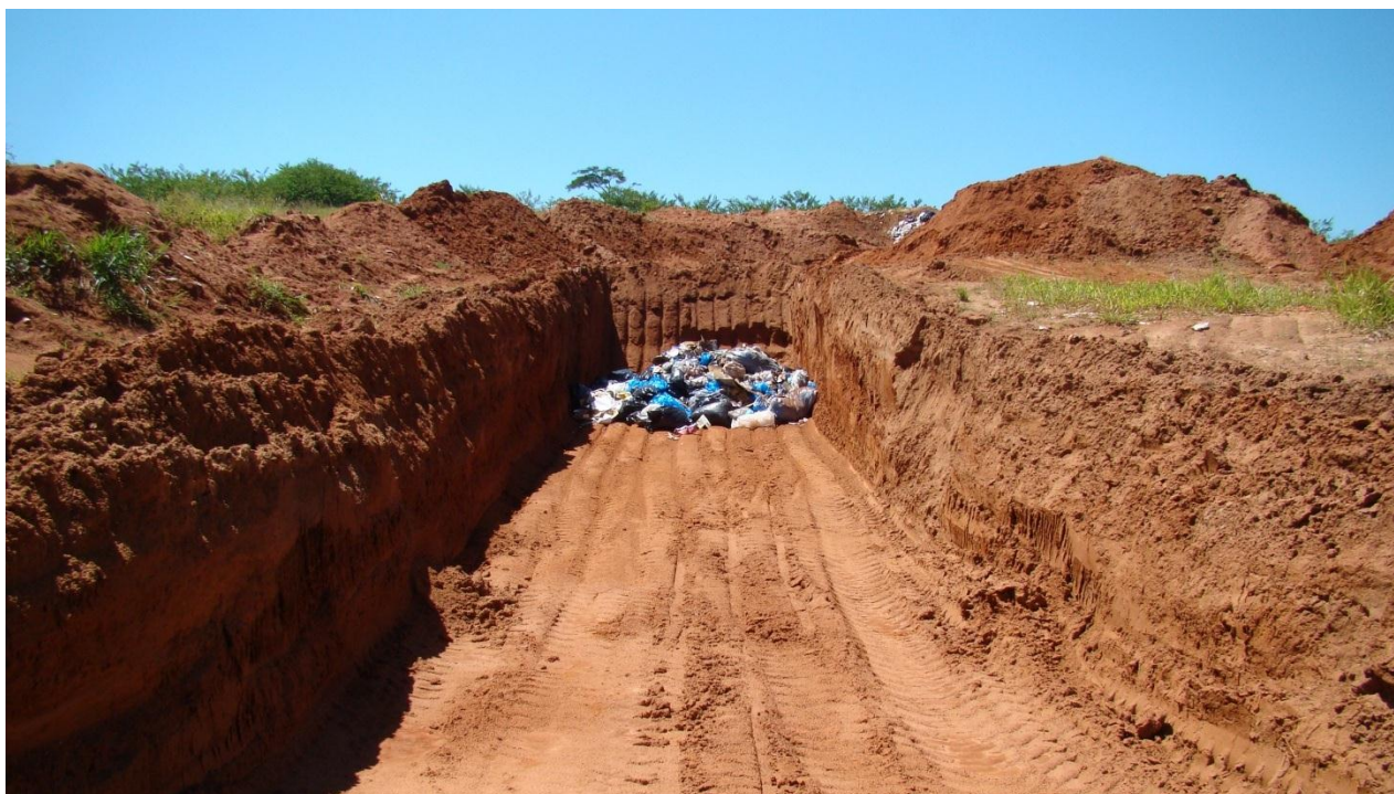
Imagem 18: vista interna do aterro em valas, com destaque para abertura de valas e destinação final dos resíduos.
