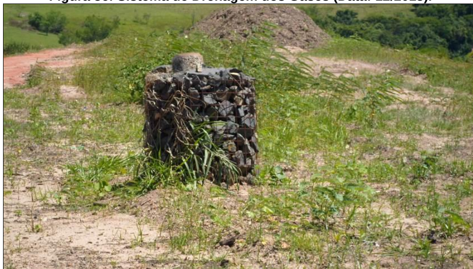
Figura 36: Sistema de Drenagem dos Gases (Data: 12/2013).
