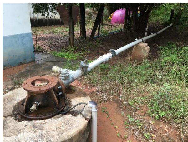
Foto 3.16 - Identificação do Poço: P16
