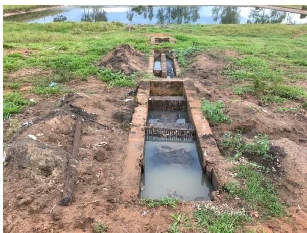
Foto 3.71 – Vista geral do tratamento preliminar ETE Guachos
