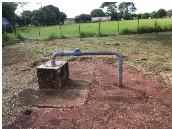
Foto 3.9 - Identificação do Poço: P09
