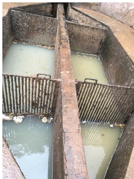
Foto 3.66 – Vista do tratamento preliminar EEEB Teçaindã
