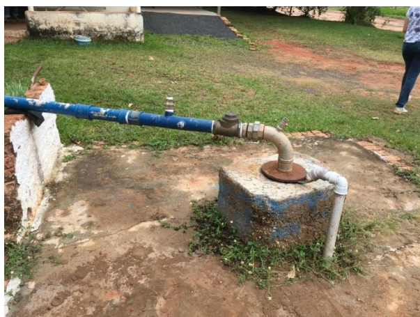
Foto 3.15 - Identificação do Poço: P15
