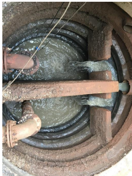
Foto 3.58 – Vista do poço de sucção EEEB São Judas Tadeu
