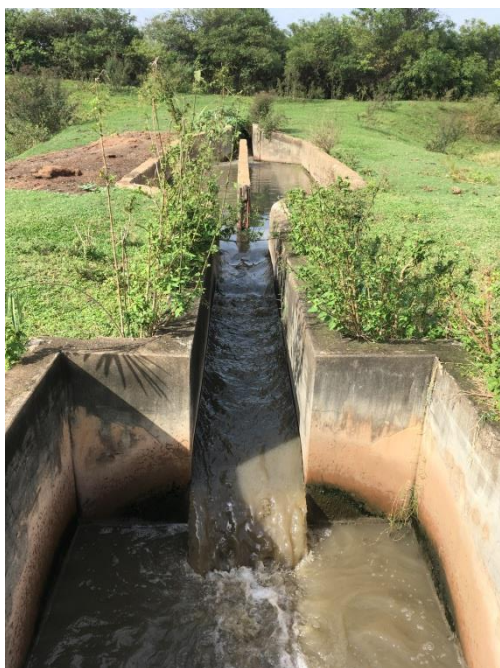
Foto 3.67 – Vista geral do tratamento preliminar ETE Capão Bonito
