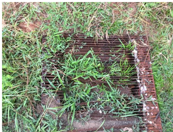
Foto 6.11 – Grade corroída retirada do canal
