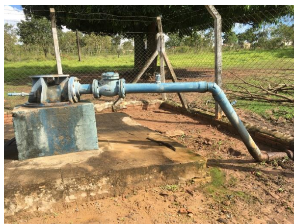
Foto 3.6 - Identificação do Poço: P06
