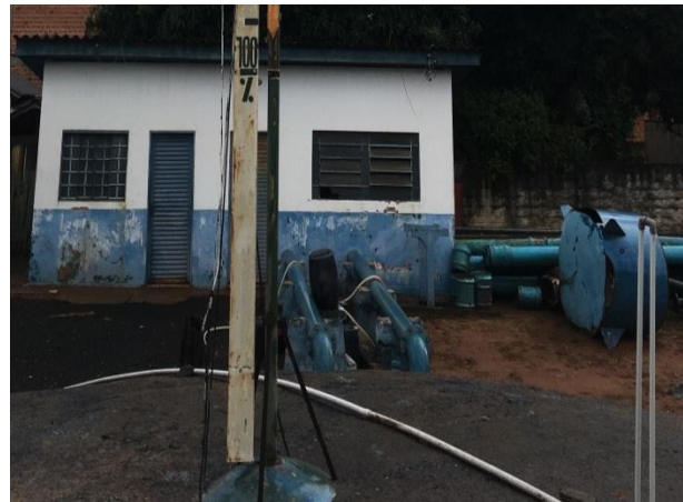
Foto 3.32 – Vista geral das tubulações de sucções e recalque da EEAT 01
