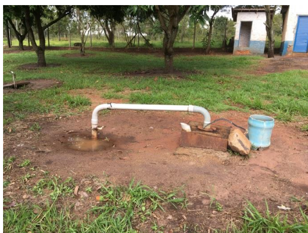
Foto 3.5 - Identificação do Poço: P05
