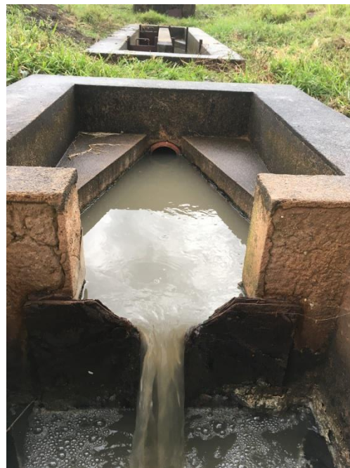
Foto 3.75 – Detalhe do vertedor triangular para medir vazão ETE Teçaindã
