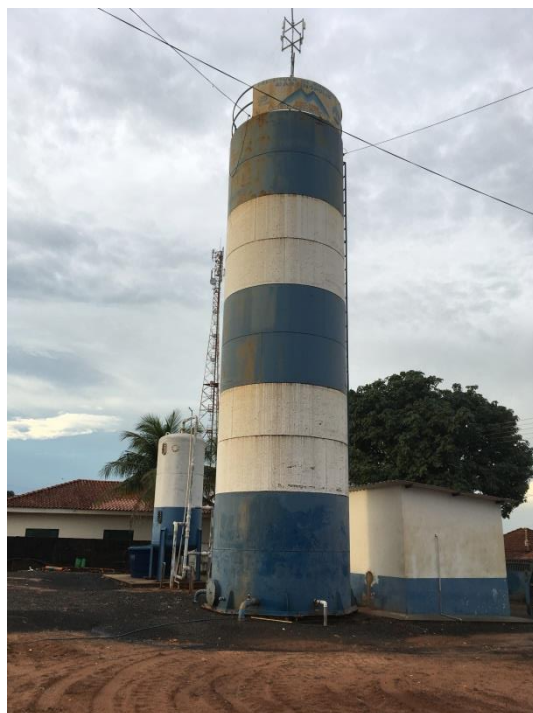
Foto 3.48 - Identificação do Reservatório: RAP 16
