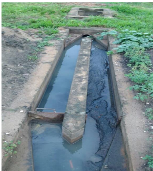
Foto 6.8 – Acúmulo de areia no desarenador
