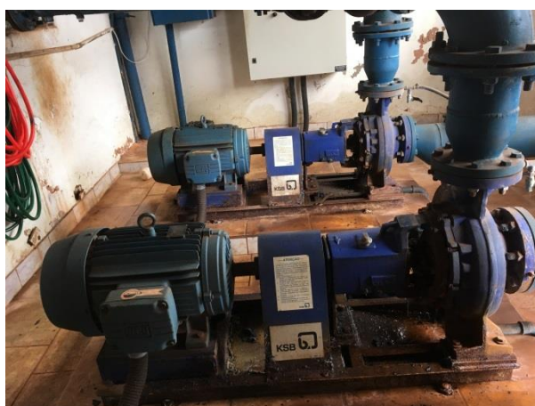
Foto 3.29- Conjuntos motor-bombas da EEAT 02
