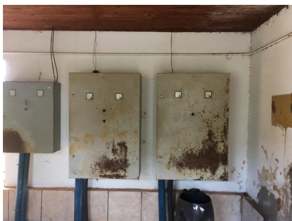
Foto 3.27- Painéis de comando da EEAT 01
