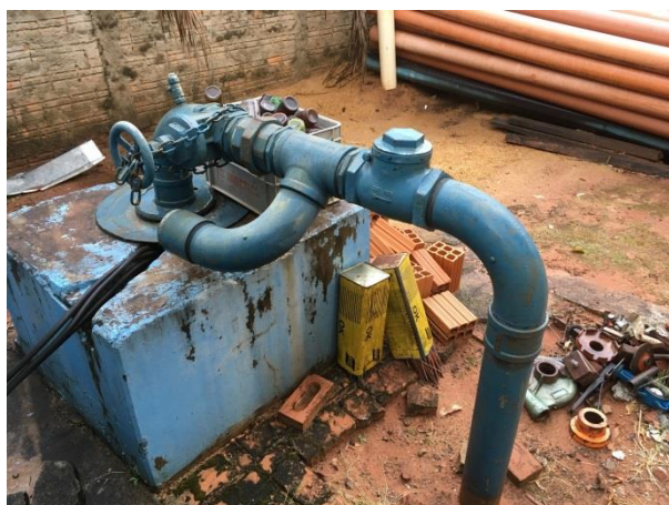
Foto 3.3 - Identificação do Poço: P03
