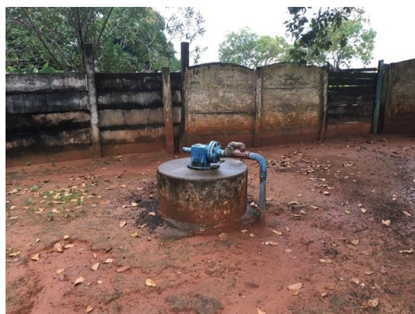
Foto 3.18 - Identificação do Poço: P18
