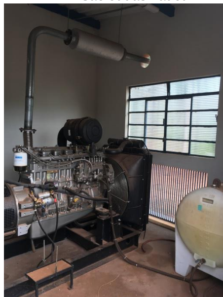
Foto 3.60 – Vista do gerador de energia EEEB São Judas Tadeu
