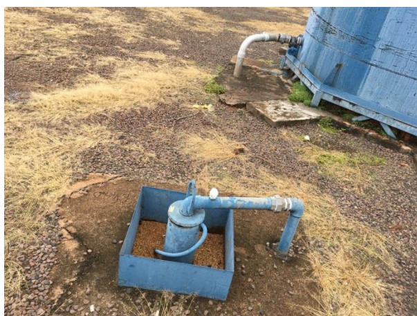
Foto 3.1 - Identificação do Poço: P01
