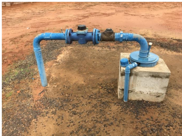
Foto 3.21 - Identificação do Poço: P21
