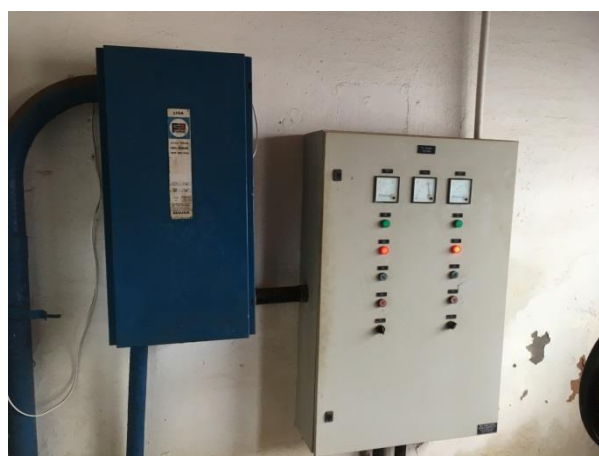
Foto 3.30 – Painel de comando da EEAT 02
