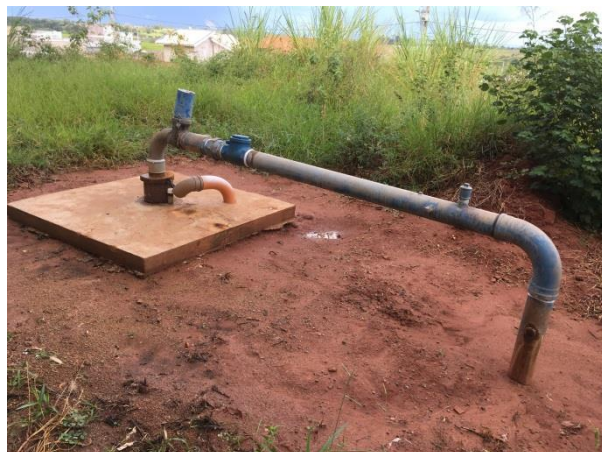
Foto 3.10 - Identificação do Poço: P10
