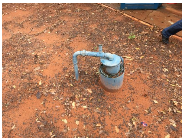
Foto 3.14 - Identificação do Poço: P14
