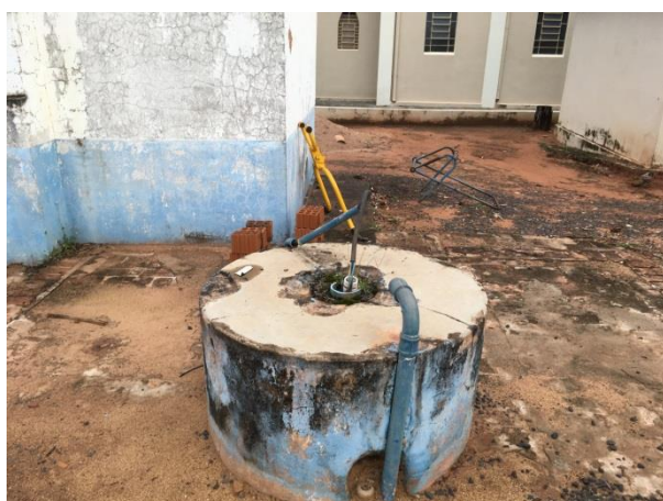
Foto 3.19 - Identificação do Poço: P19 (DESATIVADO)
