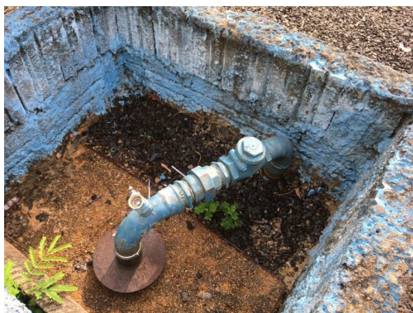
Foto 3.13 - Identificação do Poço: P13
