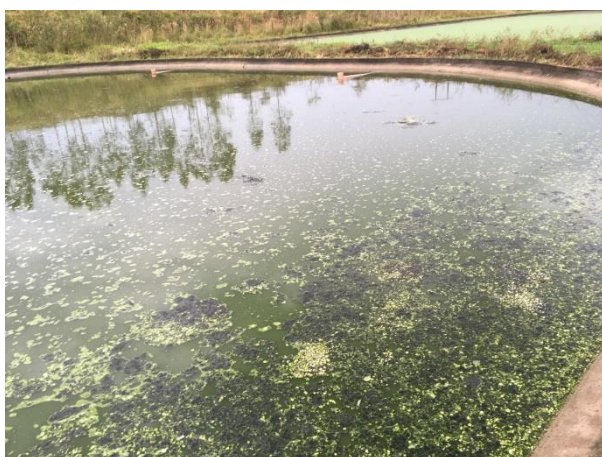
Foto 6.12 – Formação de placas de lodo desprendido do fundo da lagoa anaeróbia
