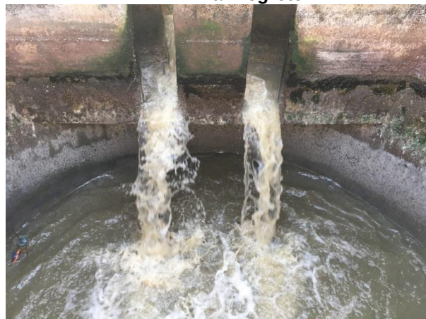
Foto 3.54 – Vista do poço de sucção EEEB Vila Alegrete
