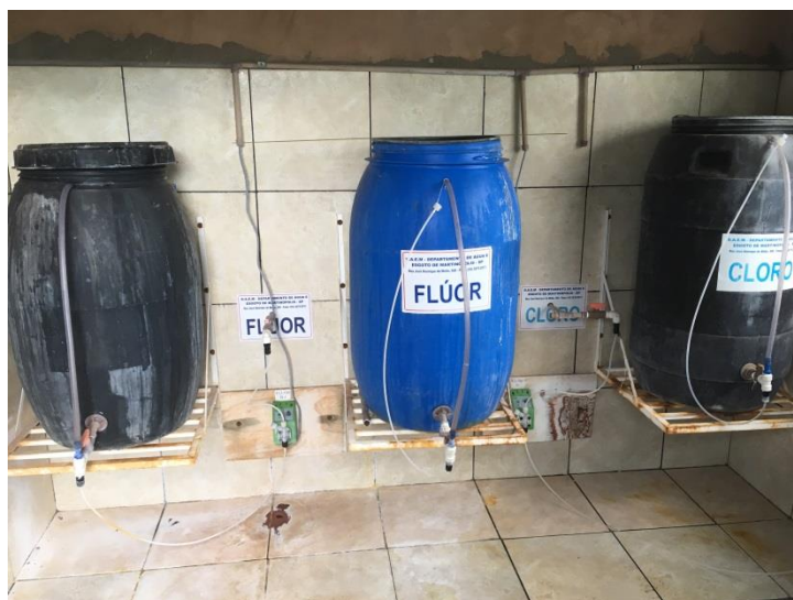
Foto 3.23 - Unidades de Fluoretação e Cloração com bomba dosadora
