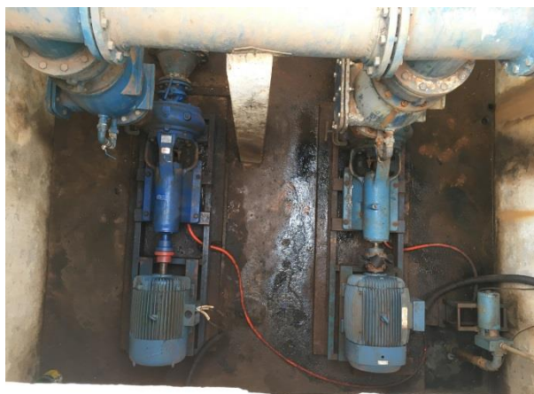
Foto 3.63 – Vista dos conjuntos motor-bombas EEEB Carmindo
