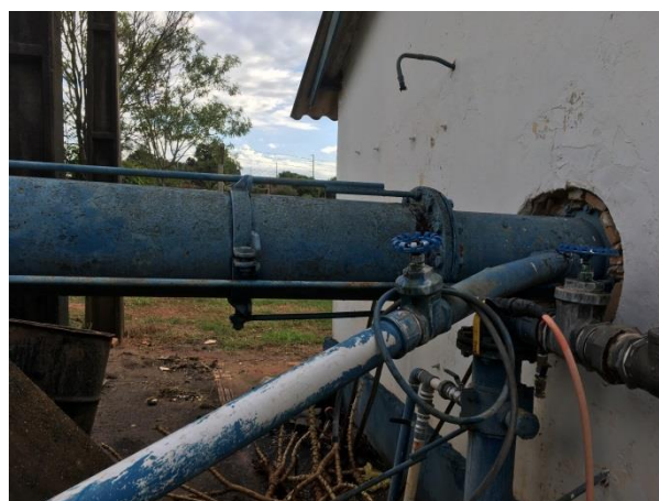
Foto 3.28 – Tubulações de recalque da EEAT 01
