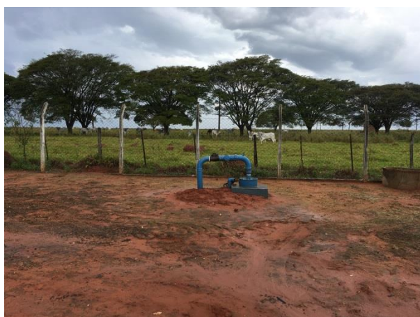
Foto 3.11 - Identificação do Poço: P11
