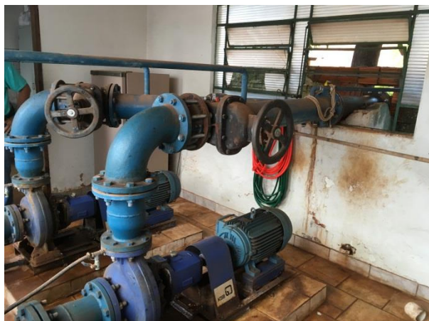
Foto 3.31- Tubulação de recalque da EEAT 01
