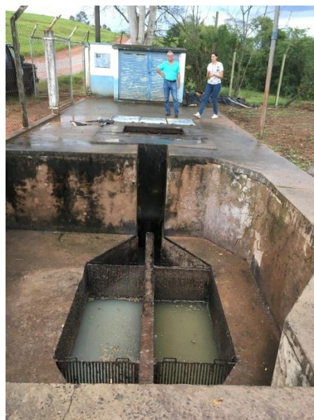
Foto 3.64 – Vista geral das unidades EEEB Teçaindã
