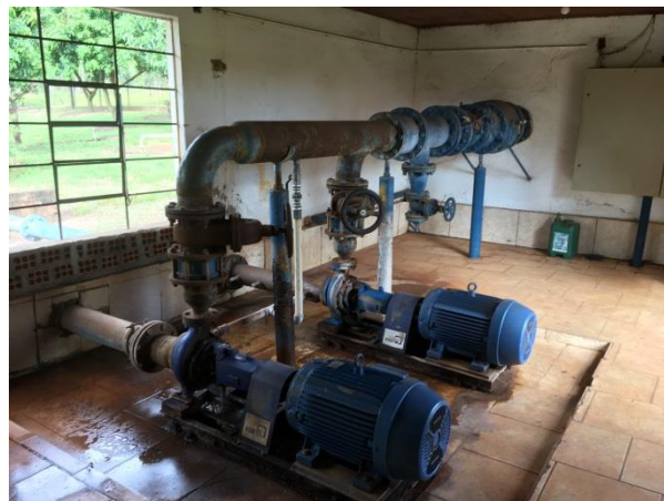
Foto 3.26 – Conjuntos motor-bomba da EEAT 01
