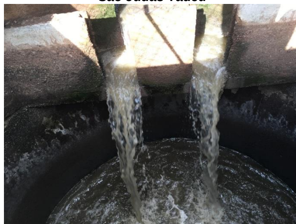
Foto 3.62 –Vista do poço de sucção EEEB Carmindo
