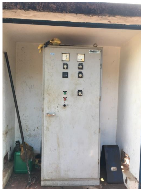
Foto 3.52 – Vista do painel elétrico das bombas EEEB Vila Alegrete
