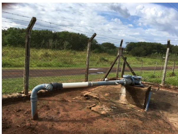
Foto 3.7 - Identificação do Poço: P07
