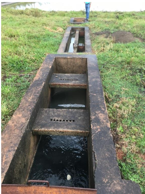
Foto 3.74 – Vista geral do tratamento preliminar ETE Teçaindã
