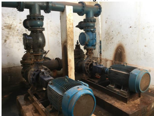
Foto 3.53 – Vista dos conjuntos motor-bombas EEEB Vila Alegrete
