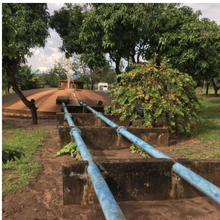
Foto 3.25- Tubulação de sucção da EEAT 01
