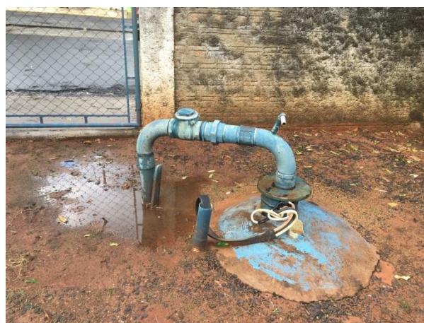
Foto 3.2 - Identificação do Poço: P02
