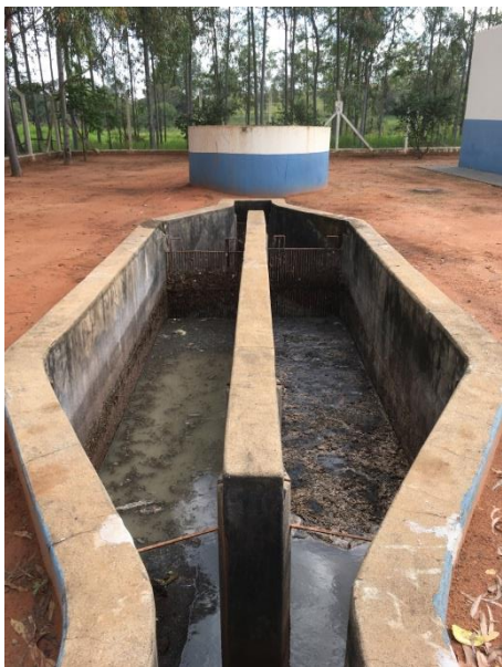
Foto 3.57– Vista dos desarenadores t EEEB São Judas Tadeu
