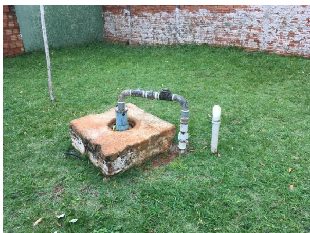
Foto 3.17 - Identificação do Poço: P17
