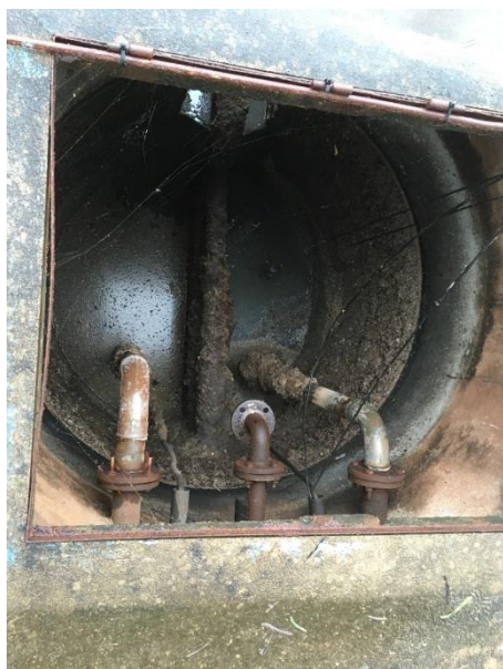
Foto 3.65 – Vista do poço de sucção EEEB Teçaindã
