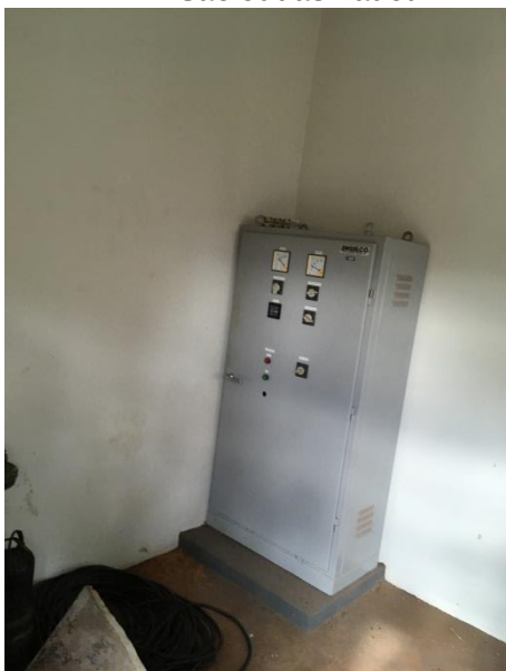
Foto 3.59 – Vista painel elétrico das bombas EEEB São Judas Tadeu
