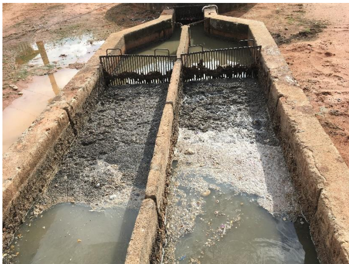
Foto 6.5 – Acúmulo de material flutuante nos desarenadores
