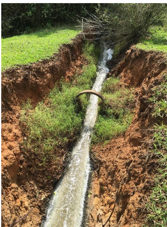
Foto 6.7 – Deterioração da tubulação de concreto
