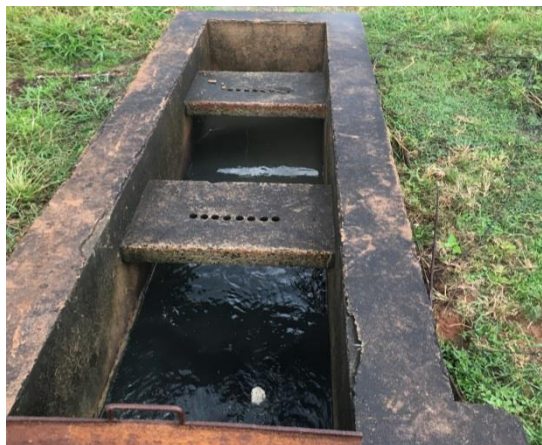
Foto 6.10 – Tratamento preliminar sem as unidades de gradeamento
