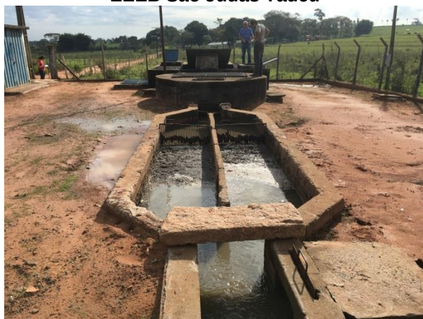
Foto 3.61– Vista geral das unidades EEEB Carmindo
