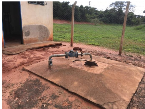
Foto 3.22 - Identificação do Poço: P22
