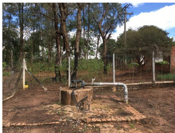
Foto 3.8 - Identificação do Poço: P08
