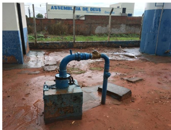
Foto 3.4 - Identificação do Poço: P04
