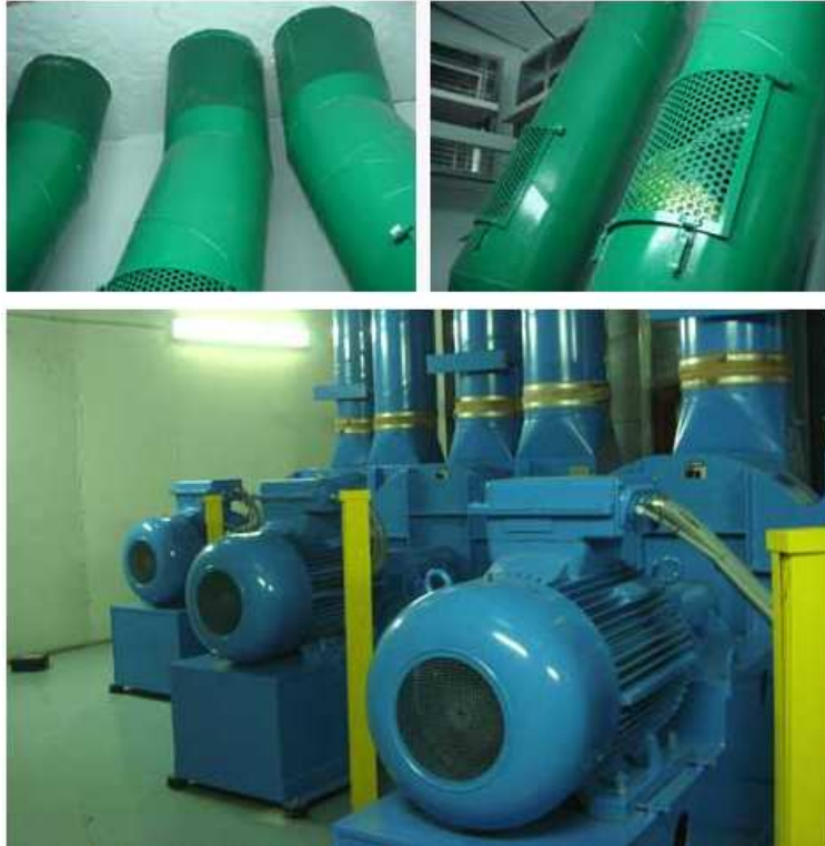
Figuras 06, 07 e 08 — Sistema de tubulações e sucção do sistema subterrâneo Fonte: G1.Globo.com, 2010
