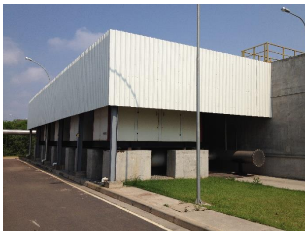
Foto 23 – Cabine acústica dos sopradores
