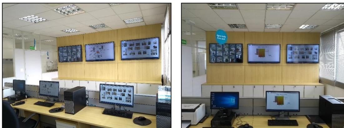
Foto 39 – CCO – Central de Controle Operacional
