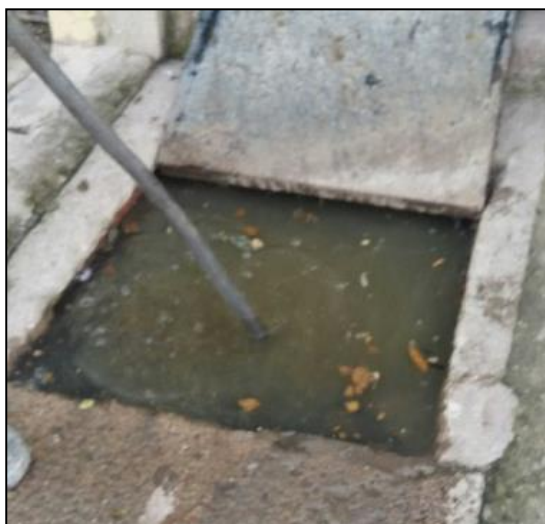
Foto 37 – Caixa de inspeção final obstruída.
