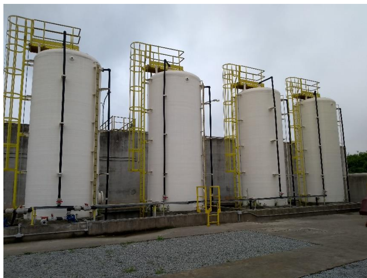
Foto 24 – Tanques de Produtos Químicos
