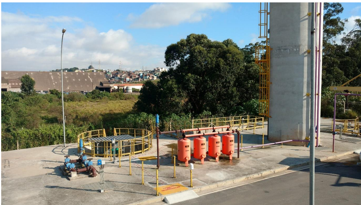
Foto 25 – Sistema de água de reuso e serviço
