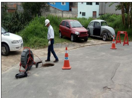
Foto 40 – Video-Inspeção de rede com equipamento SeeSnake®
