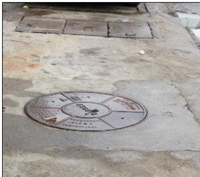
Foto 13 – Estação Elevatória 08 no passeio.
