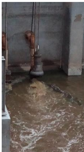
Foto 21 – Bombas de descarte de Lodo
