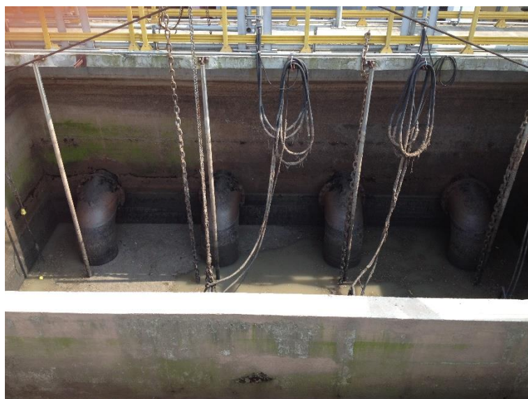
Foto 18 – Sistema de Recalque de esgoto gradeado e desarenado
