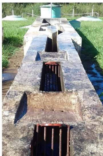
Foto 3.14 Gradeamento-- Entrada ETE
