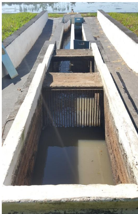
Foto 3.10 Gradeamento— Entrada ETE
