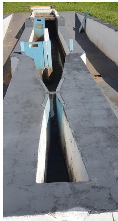
Foto 3.11 - Calha Parshall e Caixa de Areia – Entrada ETE
