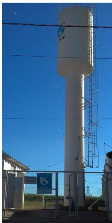
Foto 3.9 – Área dos Reservatórios 3
