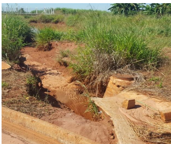
Foto 3.21 – Processo erosivo no loteamento Barreto
