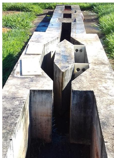
Foto 3.15 - Caixa de Areia – Entrada ETE
