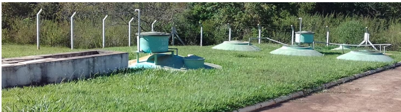
Foto 3.16 – Vista Geral dos Reatores – Vista Geral da ETE
