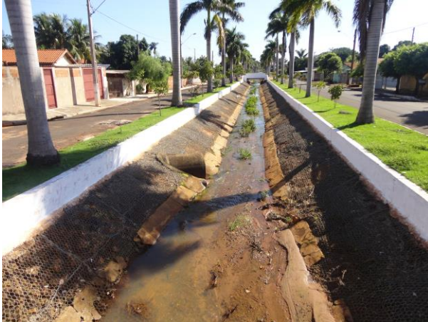
Foto 3.5 – Assoreamento no Córrego do Meio localizado no canteiro central da Av. São João
