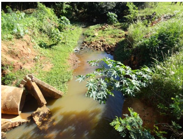
Foto 3.1 – Galeria de águas pluviais quebrada no Córrego do Meio
