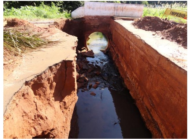
Foto 3.4 - Galeria de águas pluviais destruída por um evento de cheia no Córrego do Meio sob a via de acesso entre a R. Tocantins e a R. Rio Grande.
