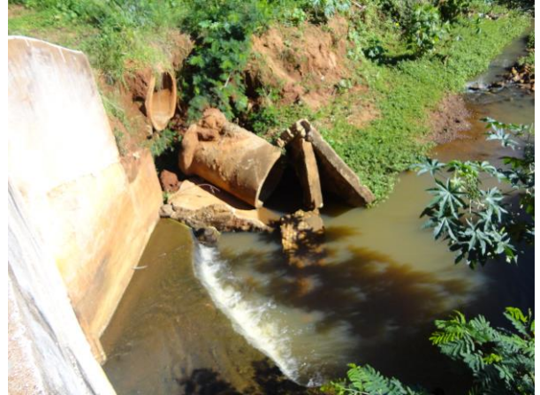
Foto 3.6 – Ponto de lançamento das águas provenientes do sistema de microdrenagem, à jusante da travessia, entre a R. Tocantins e a R. Rio Grande, no lado esquerdo do Córrego do Meio (trecho 33 do estudo de microdrenagem)
