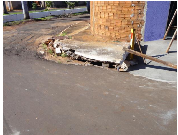
Foto 3.2- Boca de lobo quebrada próxima a Rua Tocantins
