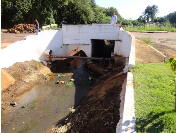
Foto 3.3 – Estrangulamento da seção da travessia, devido a tubulação de esgoto que atravessa o canal à montante da travessia entre a R. Tocantins e a R. Rio Grande.
