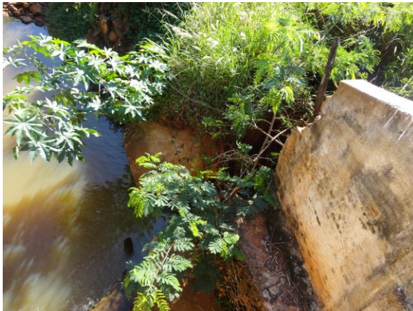
Foto 3.7 – Ponto de lançamento das águas provenientes do sistema de microdrenagem, à jusante da travessia, entre a R. Tocantins e a R. Rio Grande, no lado direito do Córrego do Meio (trecho 12 do estudo de microdrenagem)
