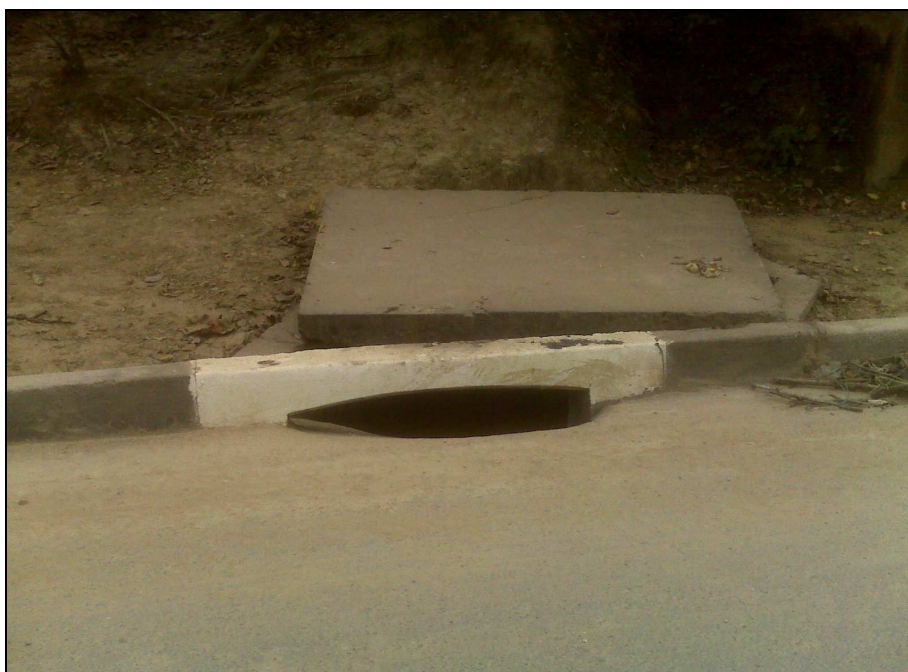
Foto 1 – Boca-de-Lobo Constatada no Município de Miracatu
