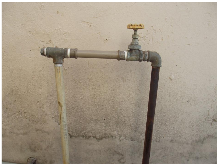
Foto 11: – Fotos Cavalete Sem Hidrômetro
