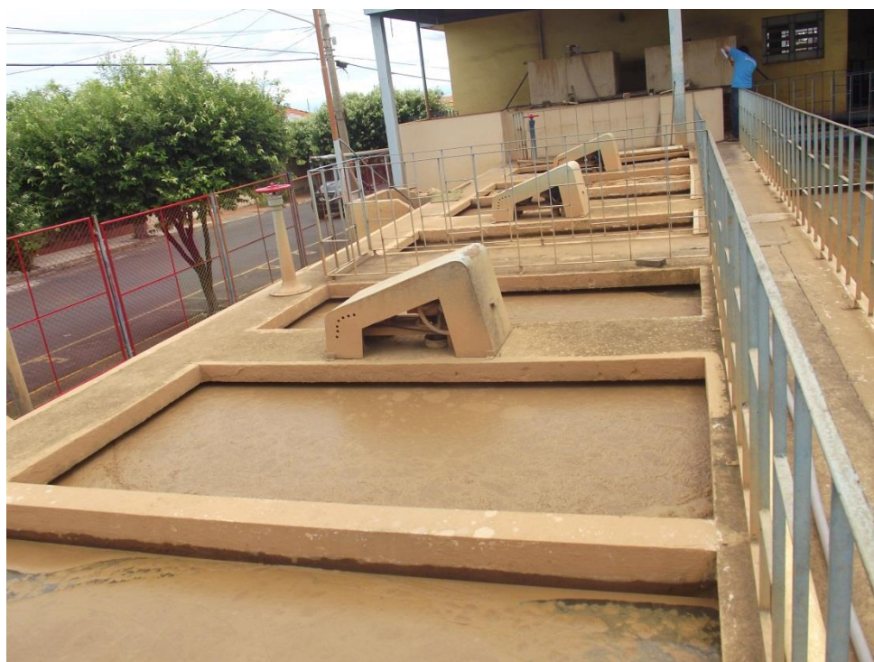
Foto 64: – Local onde é Feito a Floculação da Água Bruta e Batedouros Localização: ETA – Estação de Tratamento de Água
