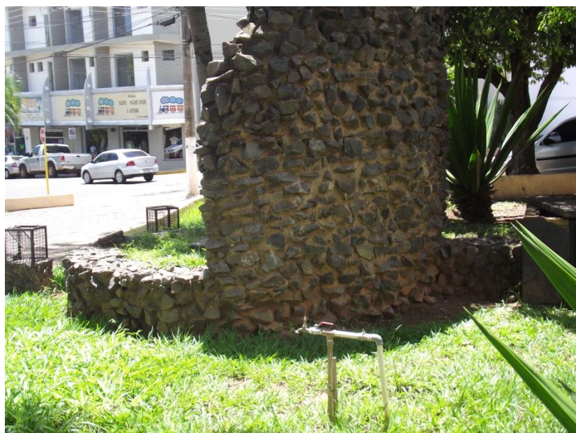
Foto 12: – Fotos Cavalete Sem Hidrômetro
