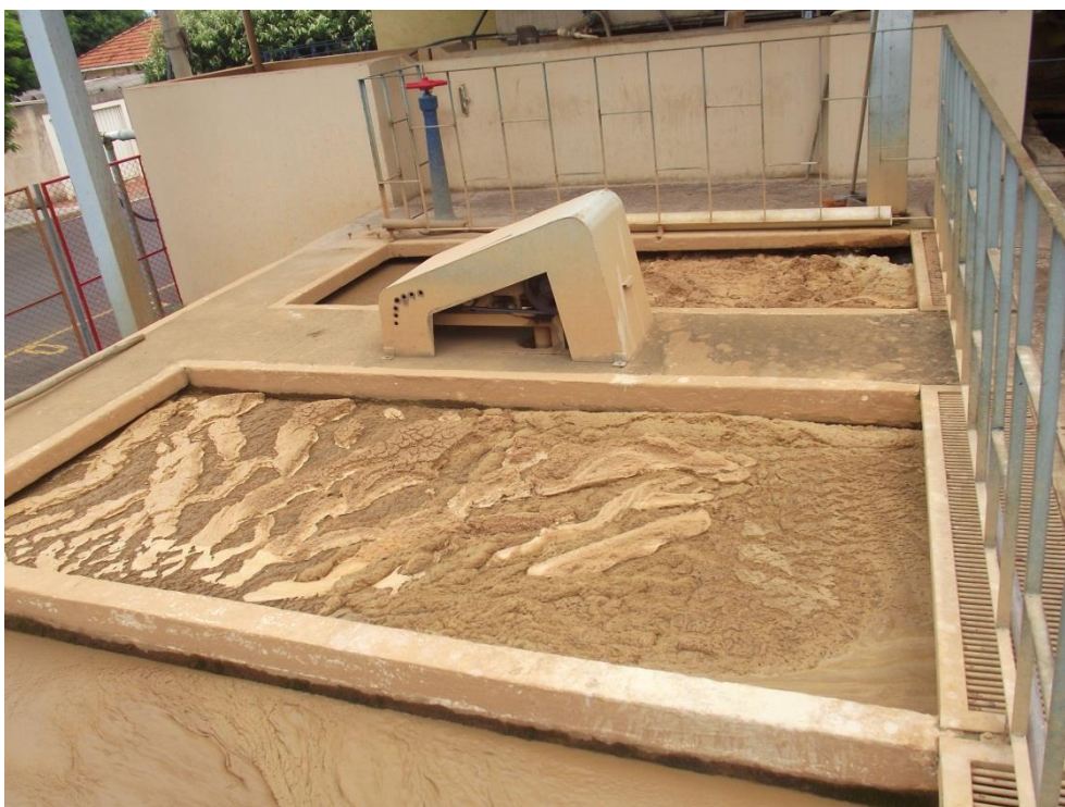
Foto 63: – Local onde é Feito a Floculação da Água Bruta e Batedouros Localização: ETA – Estação de Tratamento de Água
