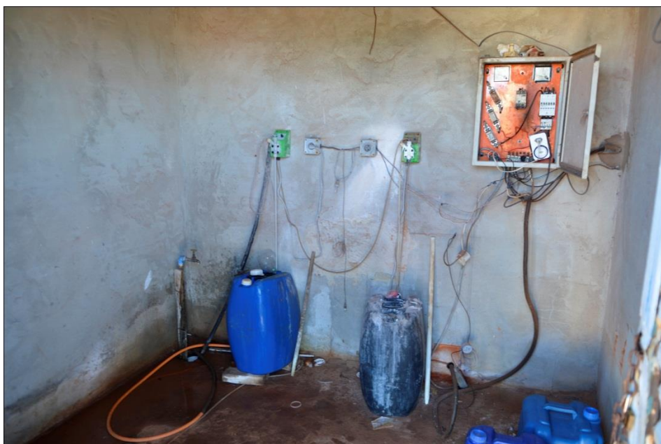
Foto 119: – Bombas Dosadoras e Paineis de Comando – Poço P20 Localização: CDHU / Sonho Meu
