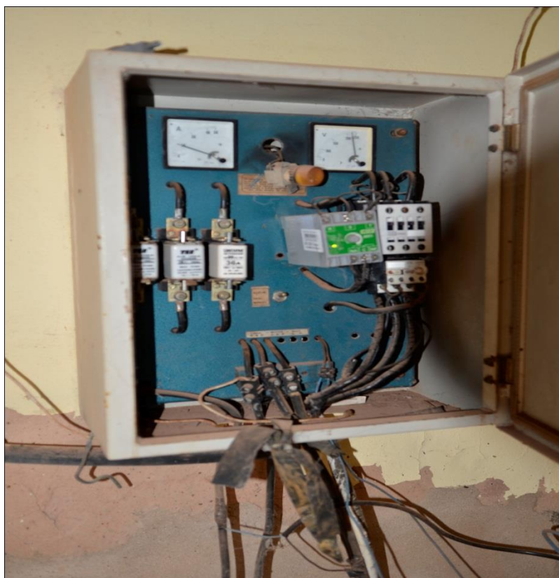
Foto 124: – Painel De Comando Localização: Bairro Amandaba
