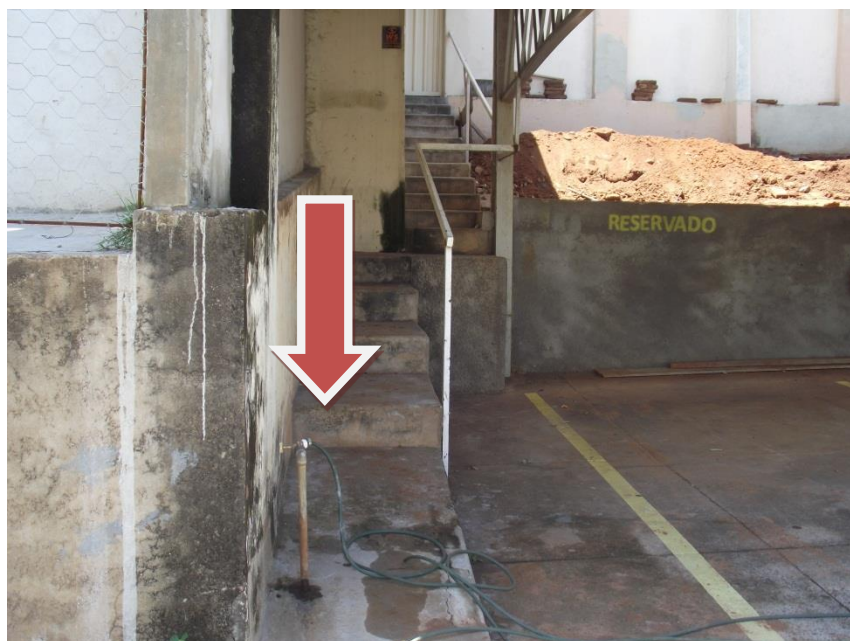
Foto 13: - Fotos Cavalete Sem Hidrômetro
