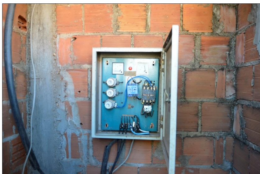
Foto 125: – Painel De Comando Localização: Bairro Amandaba
