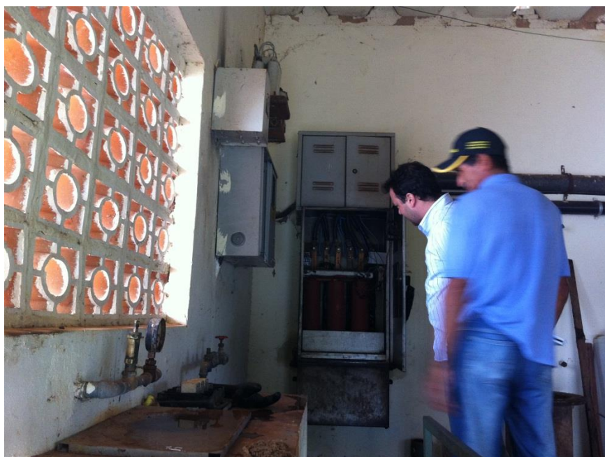
Foto 47: – Painelelétrico dos Motores da Captação da Água Bruta Localização: Barragem Santa Helena
