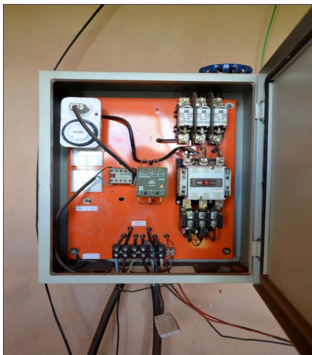
Foto 114: – Pannel de Comando – Poço P13 Localização: – Jardim Sampaio
