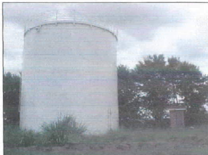
Foto 16 - Reservatório apoiado metálico - Chácara Palmeirinha
