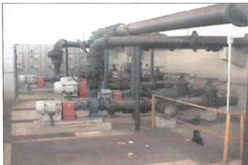
Foto 20 - Vista interna das EEAT's 01, 02 e 03
