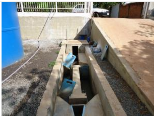
Foto 4.24 – ETE Alvorada – unidade de entrada.
