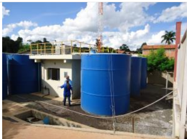
Foto 4.23 – ETE Alvorada – UASB + Aeração.
