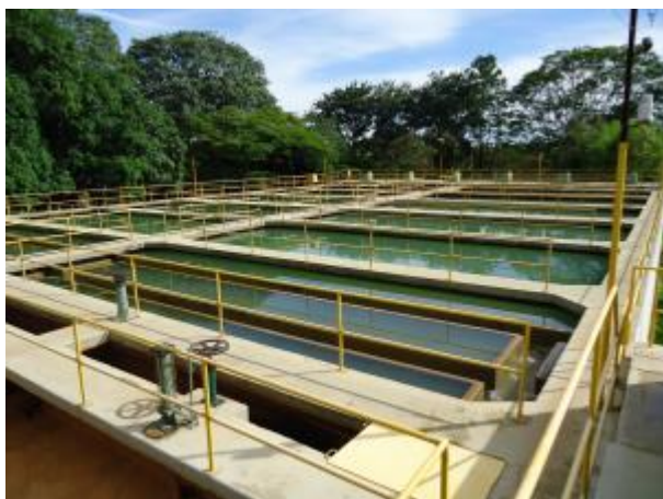
Foto 4.5 – Decantadores da ETA.
