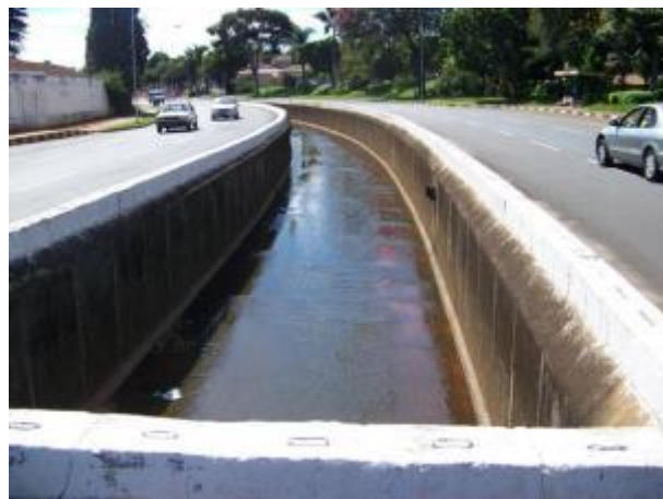
Foto 4.38 - Córrego Cantagalo. (Fonte: Plano de Drenagem, 2011)
