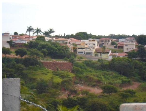
Foto 4.20 - Erosão avenida Cosmo Inforçatti
