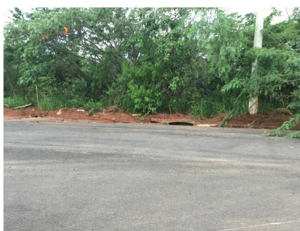
Foto 3.10 – Boca de lobo Assoreada Alto da Boa Vista
