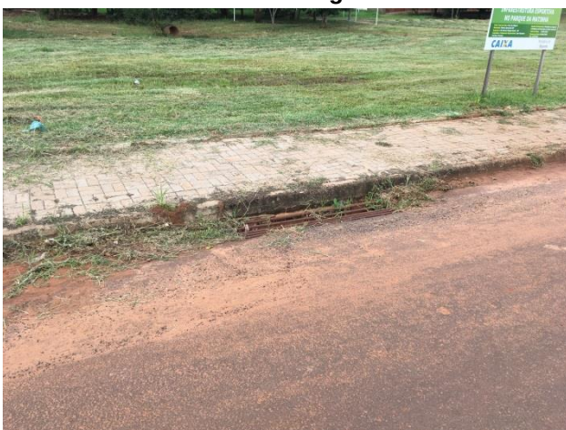
Foto 3.9 – Boca de lobo Assoreada Parque da Matinha
