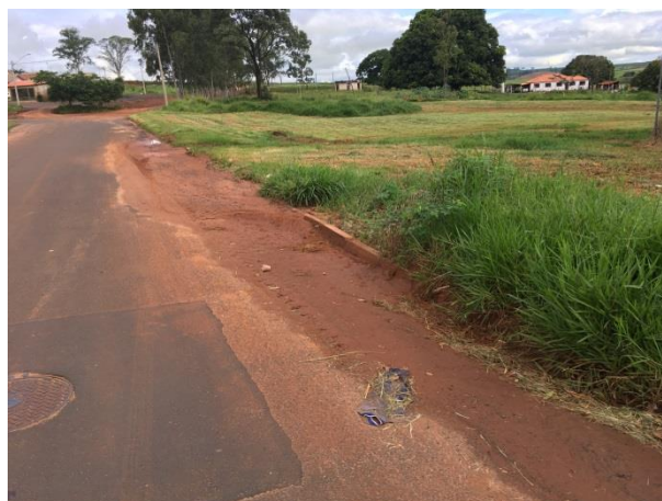
Foto 3.8 – Boca de lobo Assoreada CDHU
