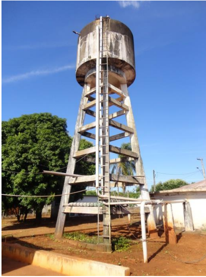
Foto 3.9 – Vista do reservatório REL-01
