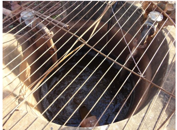
Foto 3.19 – Vista da EEE2
