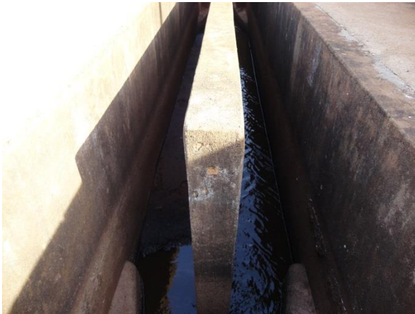
Foto 3.18 – Caixa de areia – EEE2
