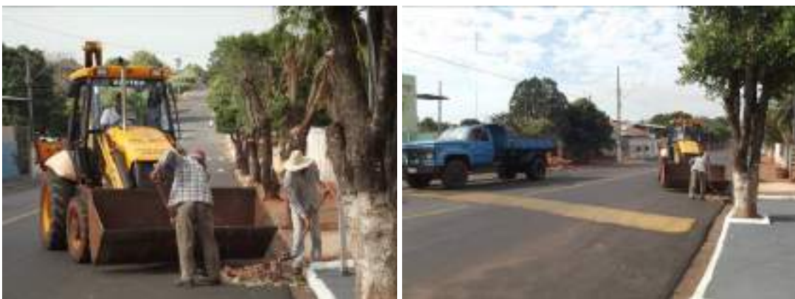
Fotos 12 e 13 – Retroescavadeira, dois auxiliares e caminhão basculante realizando a coleta dos Resíduos de Construção Civil
