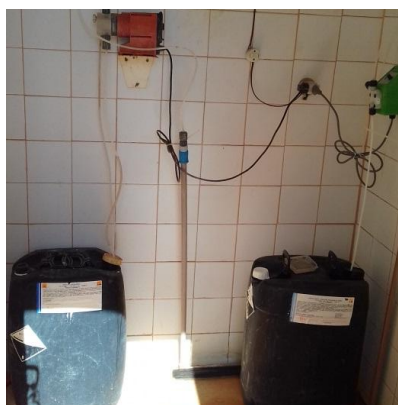
Foto 3.32 – Tratamento São José 3
