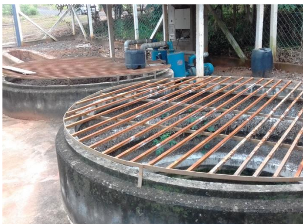
Foto 3.55 – Vista geral das unidades EEEB Jardim Nevense
