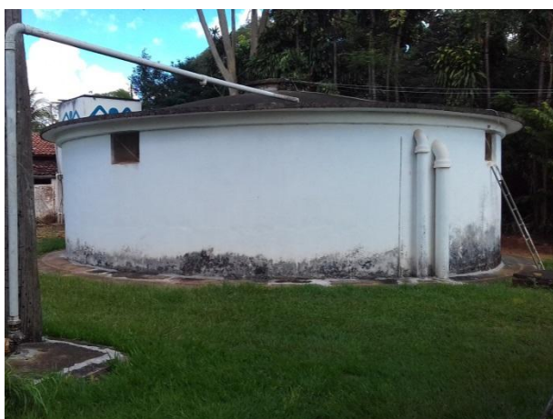
Foto 3.38 – Reservatório central semienterrado
