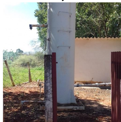
Foto 3.11 – SAA Pirajá - Reservatório
