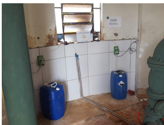
Foto 3.28 – Tratamento Sistema Central
