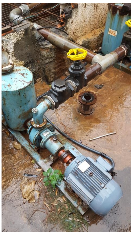
Foto 3.59 – Vista geral das unidades EEEB Central
