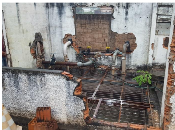
Foto 3.56 – Vista geral das unidades EEEB Central
