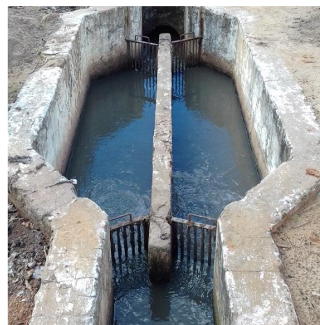
Foto 3.64 – Vista geral da ETE – Tratamento Preliminar
