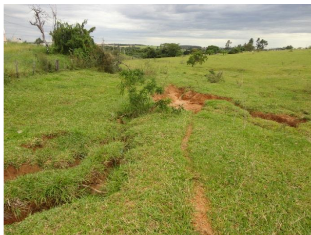
Foto 3.77 – Ponto de erosão
