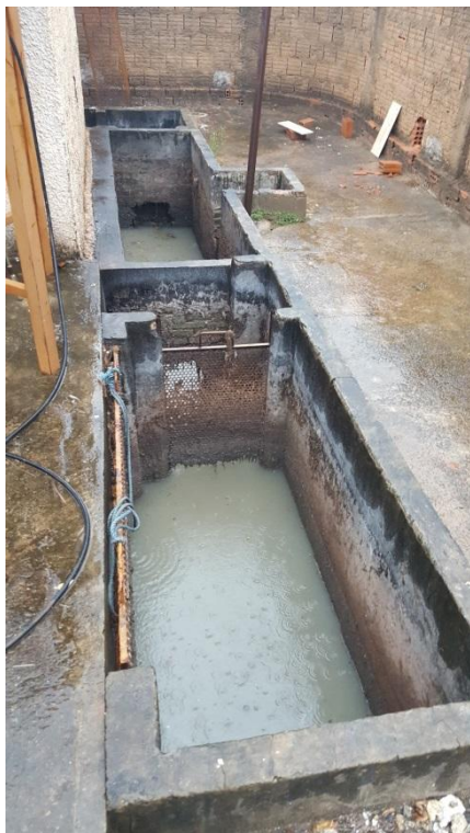
Foto 3.57 – Vista geral das unidades EEEB Central
