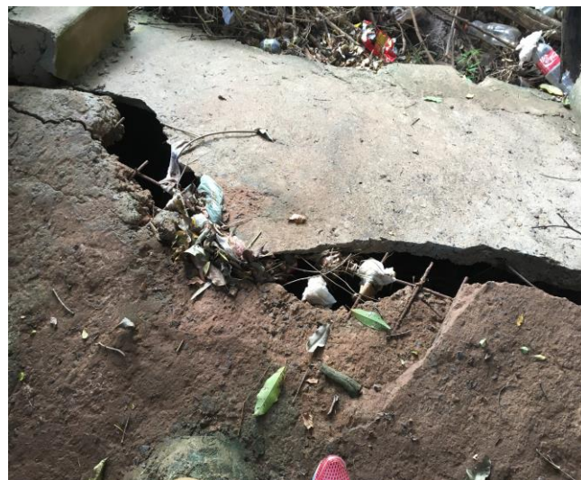
Foto 3.14 – Detalhe do final quebrado do dissipador
