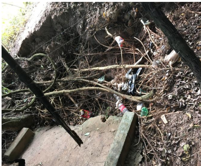
Foto 3.15 – Detalhe da pequena erosão formada ao final do dissipador
