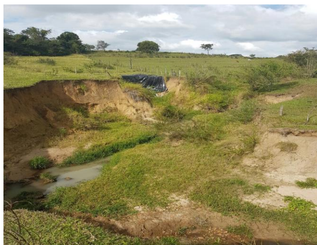
Foto 3.22 – Processo de erosão no córrego
