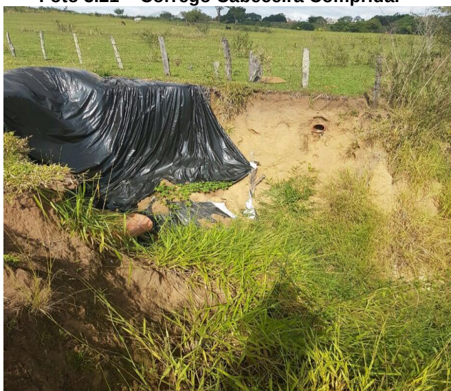
Foto 3.23 – Emissário desativado em função da erosão
