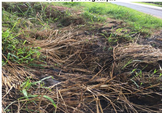
Foto 3.4 – Caixa de passagem – urgente necessidade de manutenção
