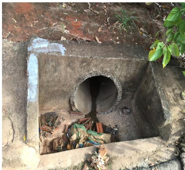
Foto 3.8 – Galeria de travessia em frente à EEE da SABESP – diâmetro insuficiente
