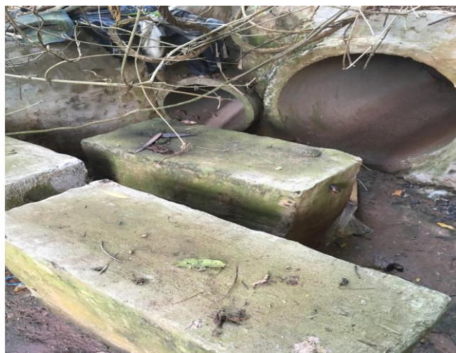
Foto 3.11 – Dissipador de águas pluviais
