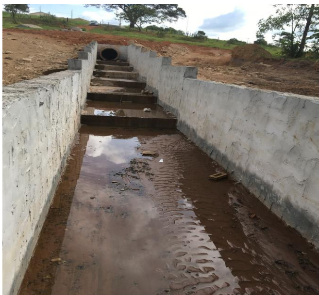
Foto 3.19 – Escada hidráulica do sistema de drenagem – CDHU Nhandeara G.
