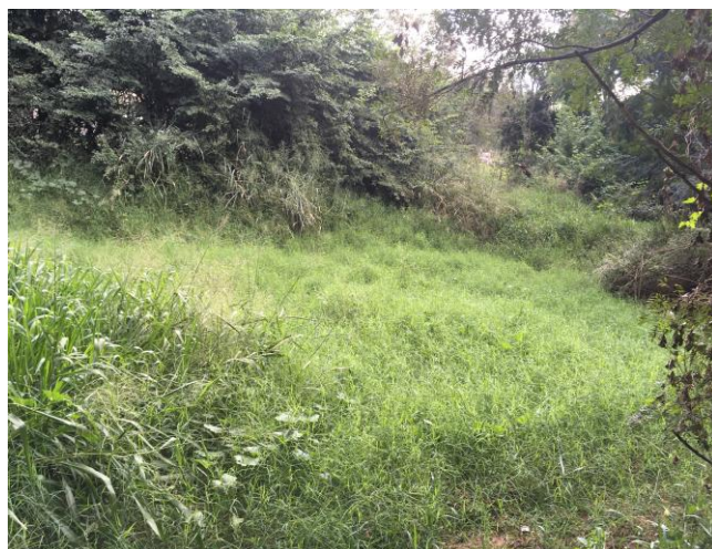
Foto 3.18 – Bacia de contenção – necessidade de manutenção
