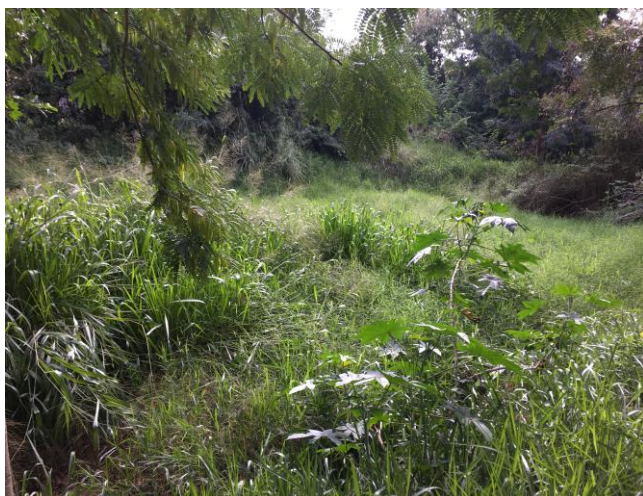
Foto 3.17 – Bacia de contenção – necessidade de manutenção
