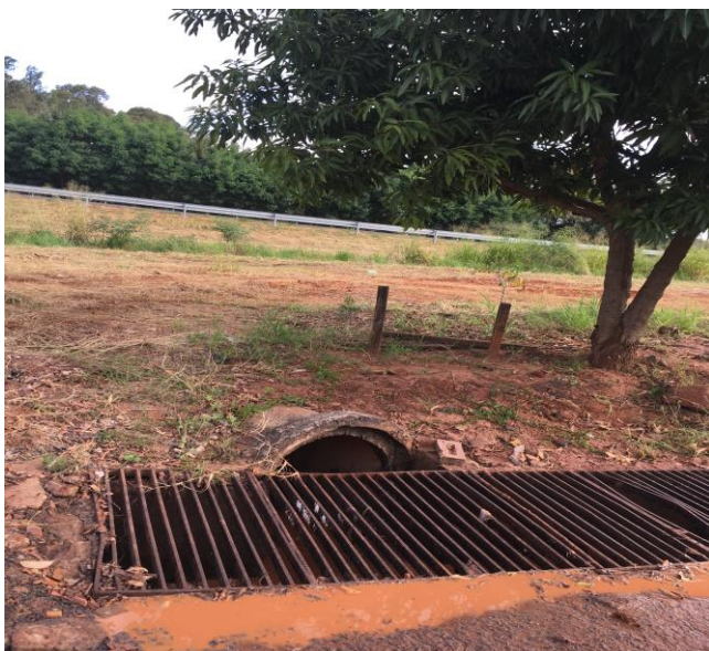
Foto 3.7 – Galeria de travessia no cruzamento da R. Leôncio. V. Lima com R. Cap. Antônio Prado
