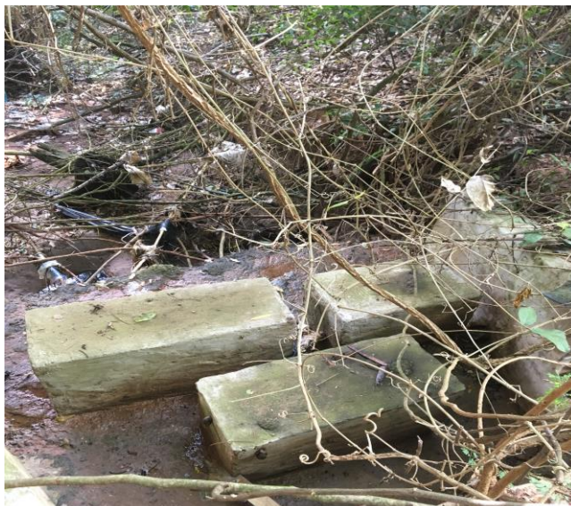
Foto 3.12 – Necessidade de manutenção no dissipador
