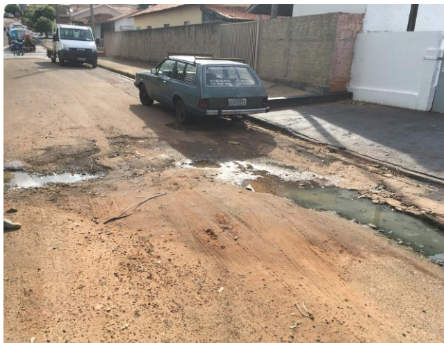
Foto 3.9 – Ponto de alagamento – Rua Leôncio V. Lima em frente à EEE nº1
