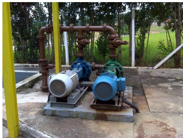
FOTO 4.10 – DETALHE DAS BOMBAS DA EEE 1
