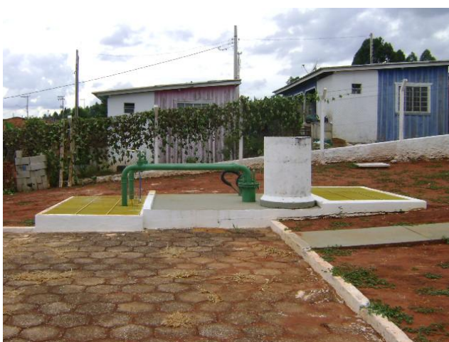
FOTO 4.5 – VISTA DO BOOSTER ZONA ALTA LONGA VIDA LOCALIZADO DENTRO DA ETA NOVA CAMPINA
