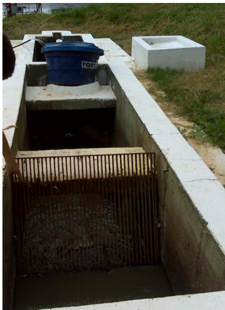
FOTO 4.11 - ETE NOVA CAMPINA - VISTA DA CAIXA DE AREIA E DO GRADEAMENTO
