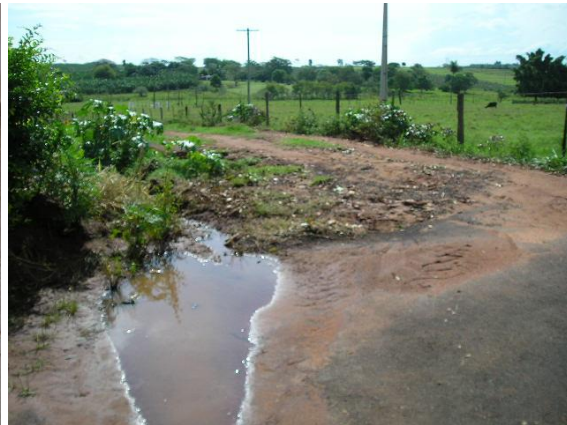
RESÍDUOS NO SISTEMA DE DRENAGEM URBANA
