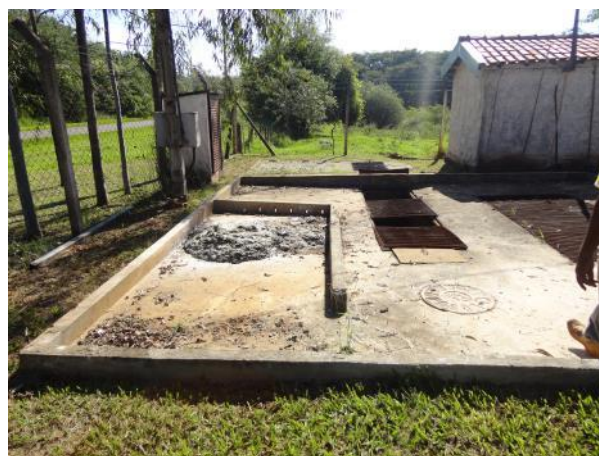
Foto 3.19 – Leito de secagem do lodo na EEE2
