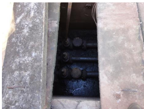
Foto 3.17 – Vista da EEE2
