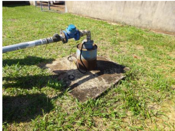
Foto 3.4 - Identificação do Poço: P04
