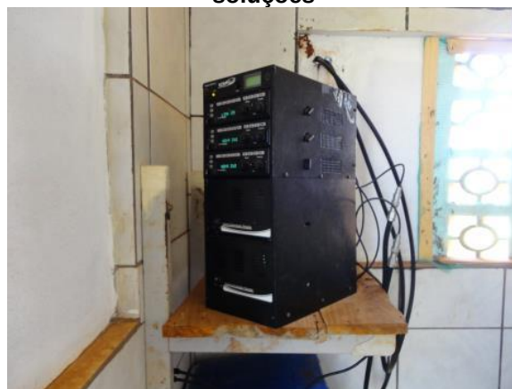
Foto 3.8 – Controlador das bombas dosadoras
