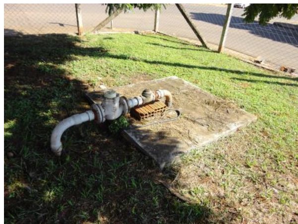
Foto 3.2 - Identificação do Poço: P02
