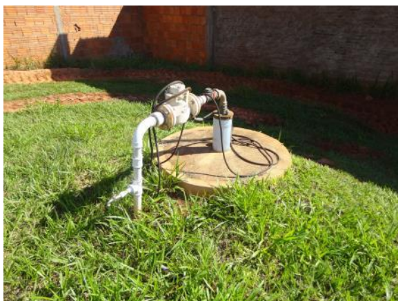
Foto 3.3 - Identificação do Poço: P03
