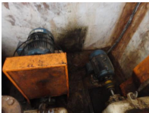
Foto 3.18– Conjunto de Bombas EEE2
