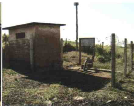
POÇO SÃO JOSE I
