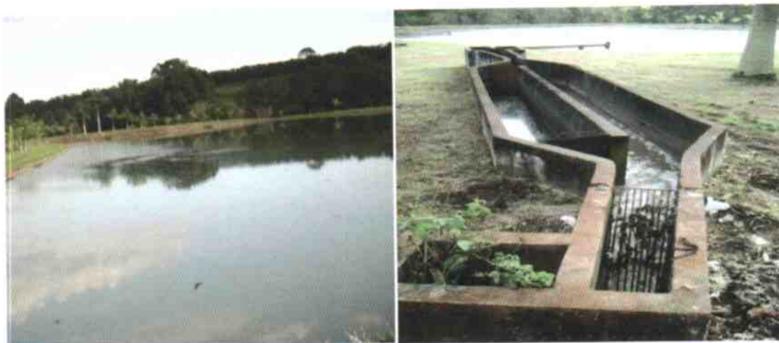
Lagoa de tratamento de esgoto
