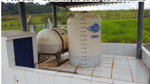
Foto 3.21 – Identificação do tanques de cloro do Sistema de Desinfecção
