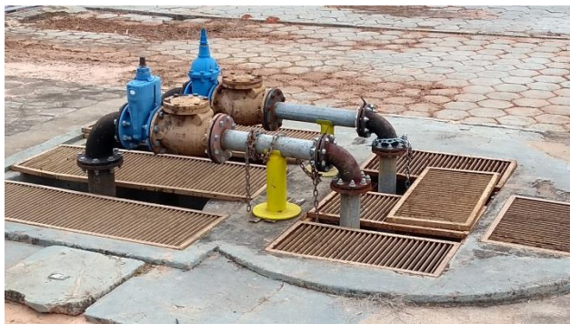
Foto 3.15 – Identificação dos conjuntos motor-bomba da EEE 3 Final
