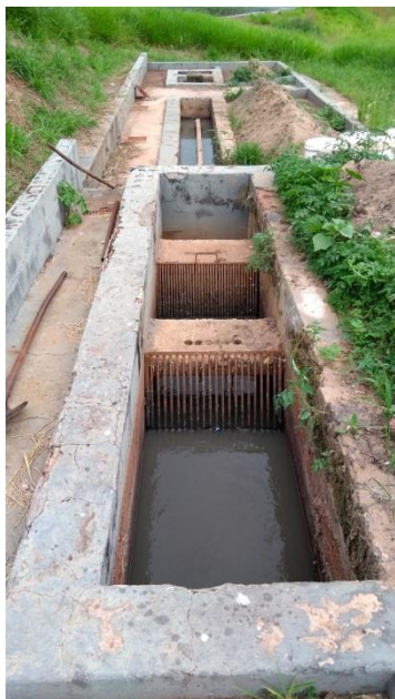
Foto 3.17 – Vista do Tratamento Preliminar
