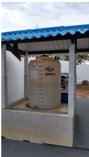
Foto 3.10 – Tanque de Hipoclorito de Sódio
