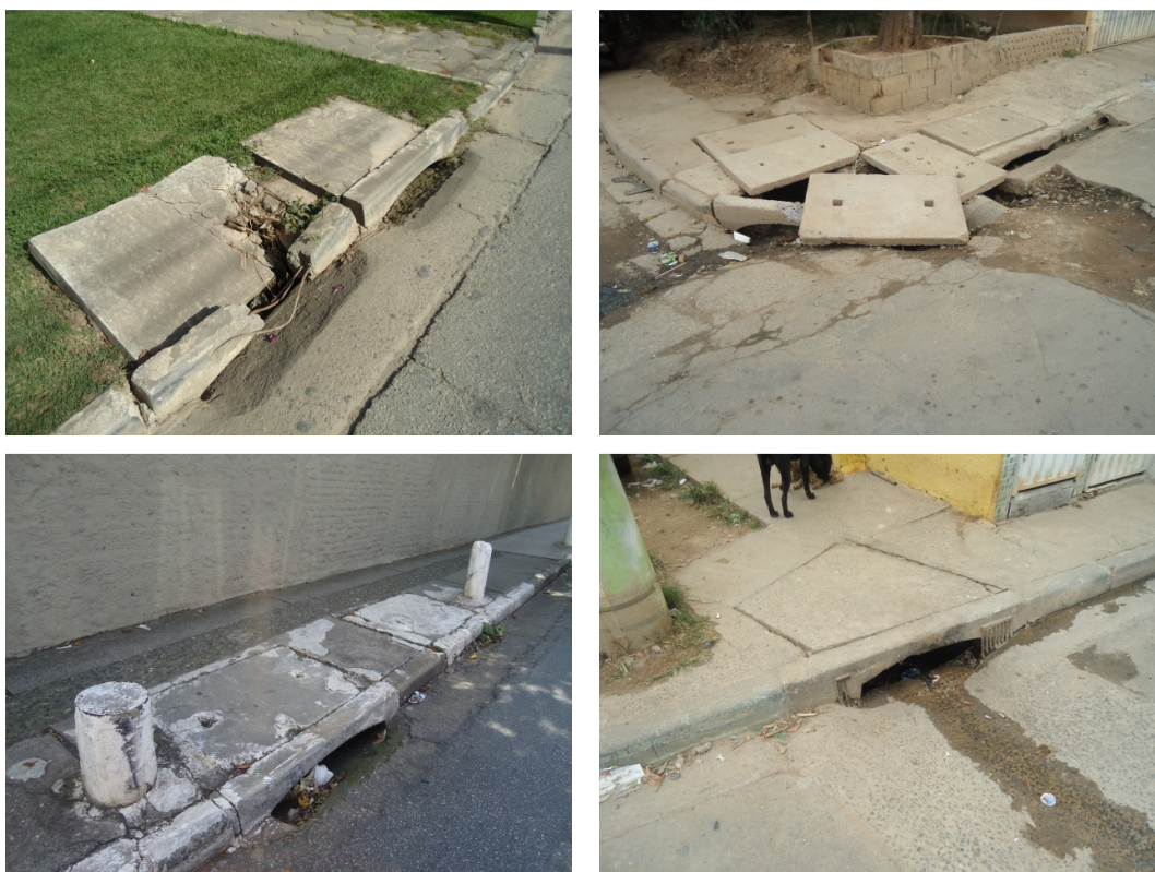
Figura 45 – Dispositivos de microdrenagem insuficientes e necessitando de manutenção e limpeza
