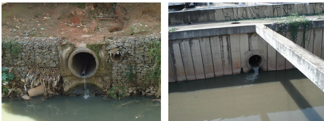
Figura 21 – Galerias de águas pluviais sem concordância hidráulica no Córrego Bussocaba
