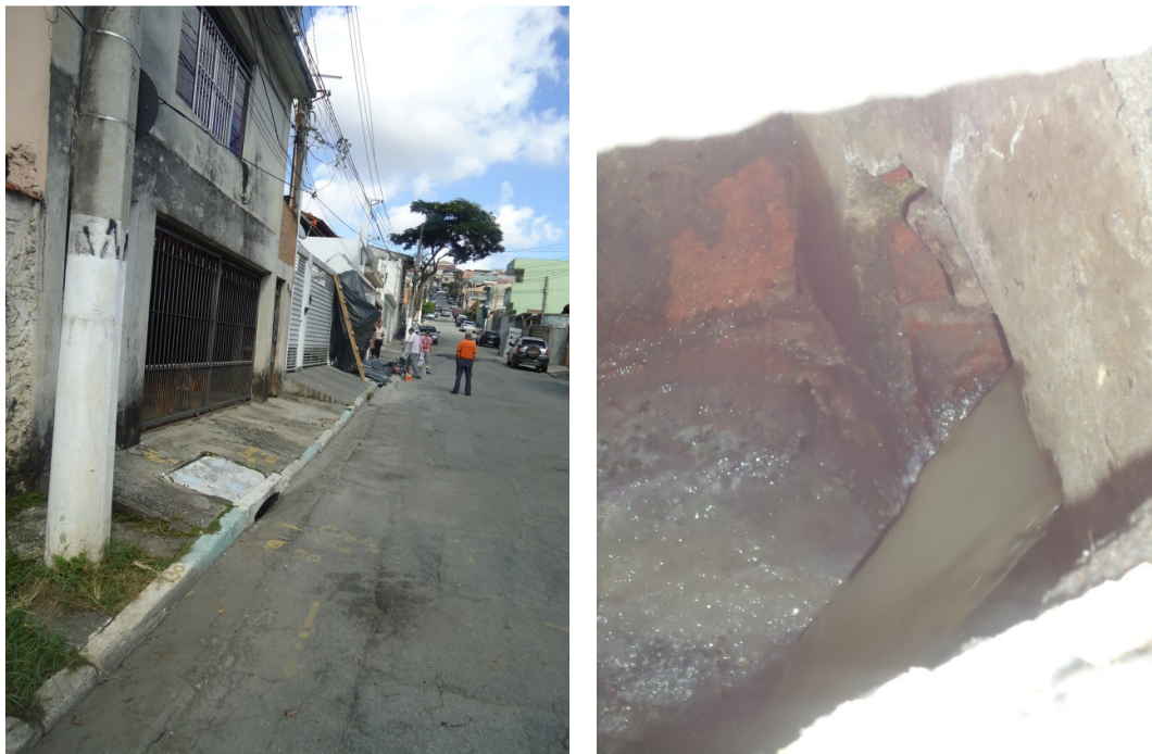
Figura 47 – Lançamento de esgoto em boca de lobo na bacia do córrego Golfe Clube
