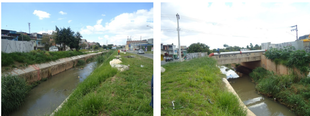
Figura 4 – Canalização no Ribeirão Vermelho – destaque para a grande quantidade de sedimentos depositados na calha
