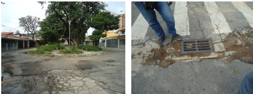
Figura 40 – Ponto de inundação na bacia do córrego Quitaúna, afluente do Ribeirão Carapicuíba, detalhe para o desgaste do leito carroçável
