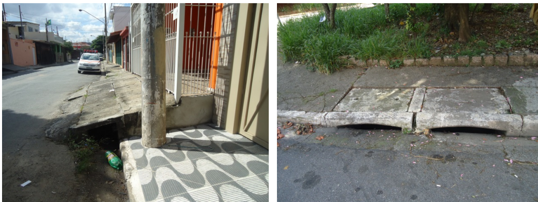
Figura 42 – Ponto de inundação na Bacia do córrego João Alves, destaque para a elevação das entradas das residências
