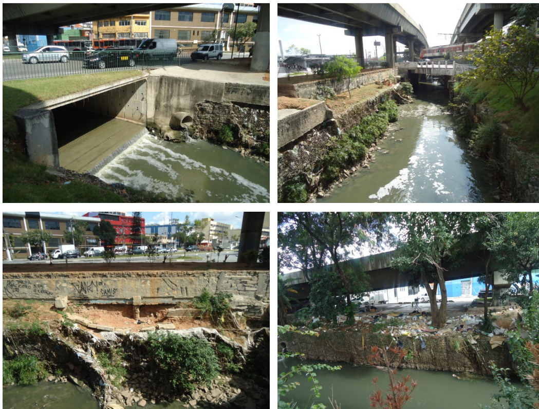
Figura 20 – Córrego Bussocaba próximo a Praça Antônio Menk, travessias, presença de esgoto, resíduos sólidos e gabião danificado
