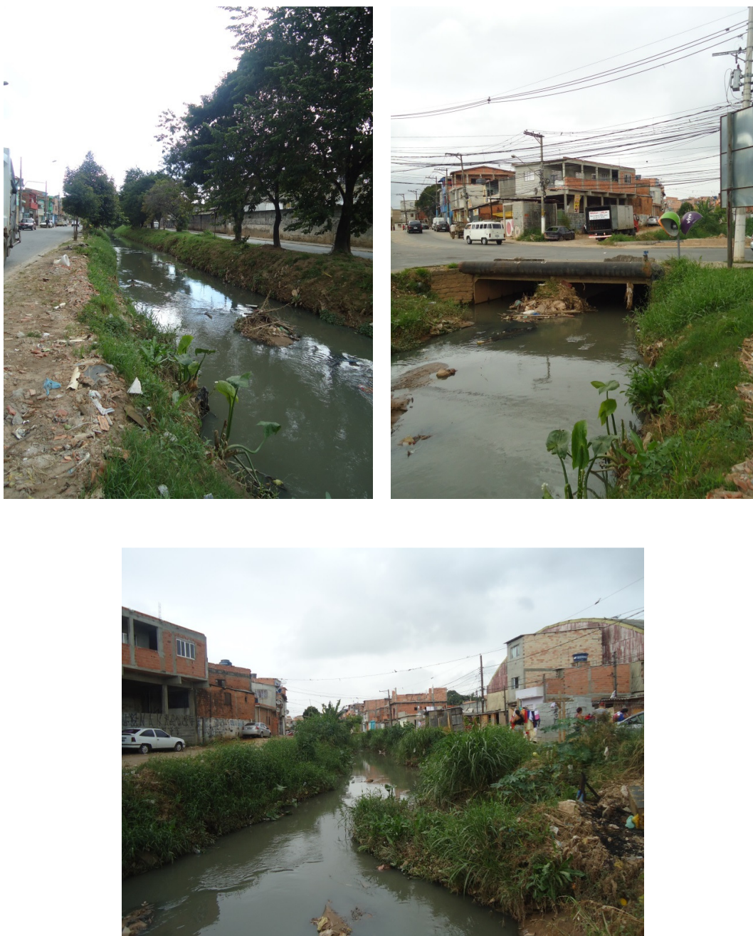
Figura 15 – Córrego Baronesa, entre as Avenidas Lourenço Belolli e Presidente Médici, detalhe para a calha assoreada, presença de resíduos sólidos e ocupação das margens
