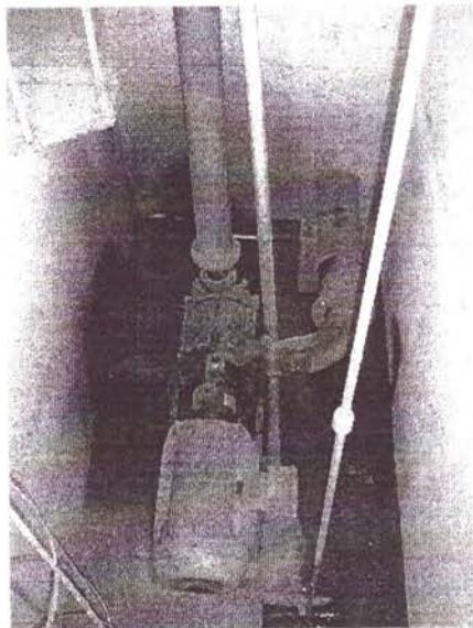
Foto 2: Bomba em funcionamento.
