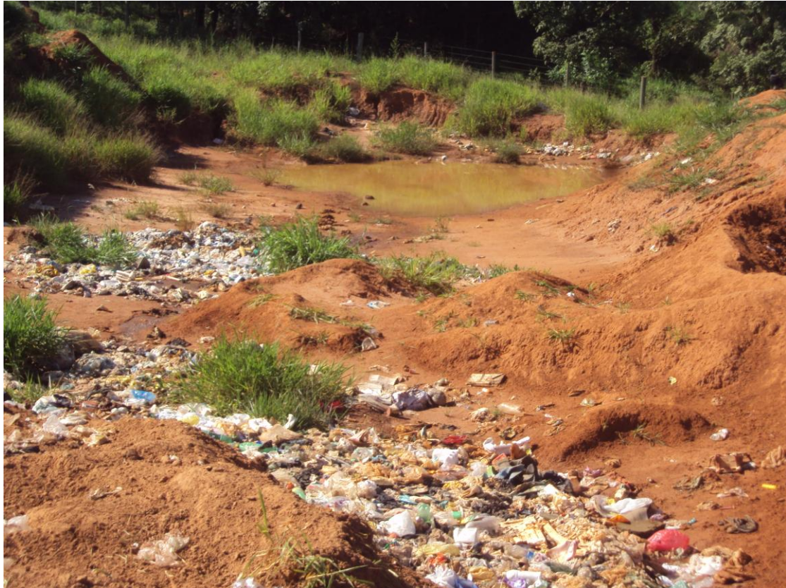
Foto 15 – Resíduos acondicionados fora das valas de aterramento
