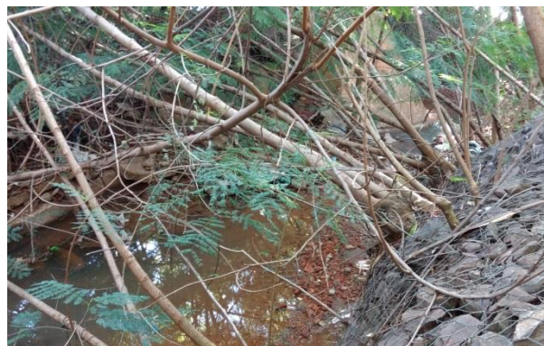
Foto 3.75 - Ponto 9: Galeria quebrada: Próxima ao cruzamento da Alameda das Hortências x Alameda das Rosas
