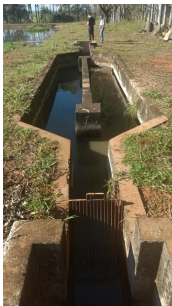
Foto 3.43 - Tratamento Preliminar – Entrada ETE
