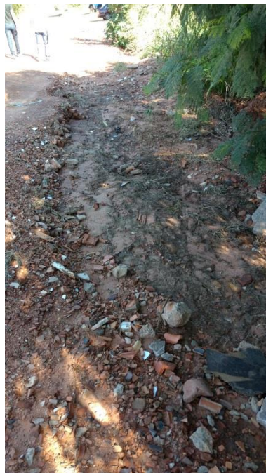
Foto 3.76 - Erosão na rua Vinte e Oito
