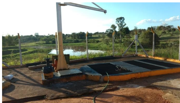
Foto 3.38 - EEE – Ponte Nova
