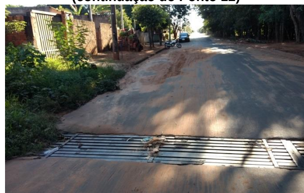
Foto 3.72 - Ponto 15: Rua Quintino Maudonnet x Avenida P
