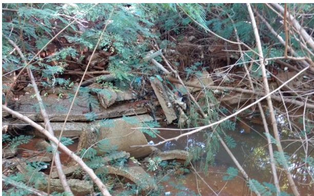
Foto 3.74 - Galeria quebrada: Próxima ao cruzamento da Alameda das Hortências x Alameda das Rosas
