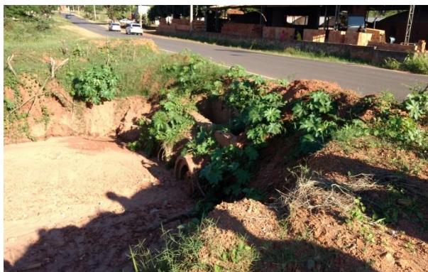
Foto 3.69 - Ponto 12: Rua Pedro Milaniz x Avenida G (Ponto de alagamento + Erosão)
