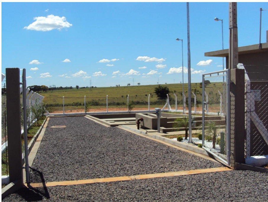
Foto 14 - Tratamento de Esgoto Compacta no Distrito de Sapezal.
