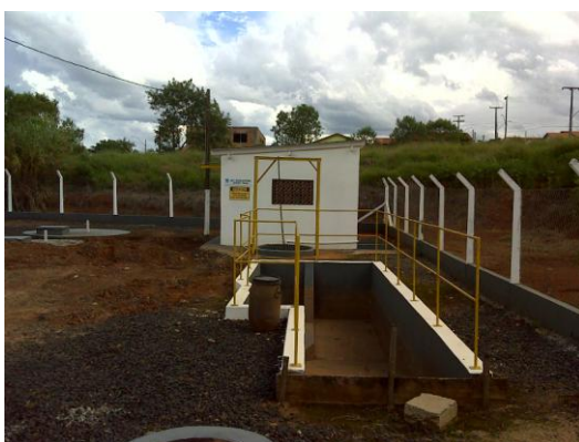
FOTO 4.19– ESTAÇÕES ELEVATÓRIAS DE ESGOTO TOPAZIO.
