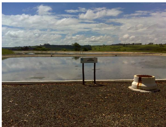
FOTO 4.14– LAGOA ANAERÓBIA ETE PARANAPANEMA
