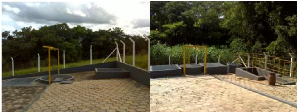
FOTO 4.15 E FOTO 4.16– ESTAÇÕES ELEVATÓRIAS DE ESGOTO FIGUEIRAS (ESQUERDA) E TILIAS (DIREITA).
