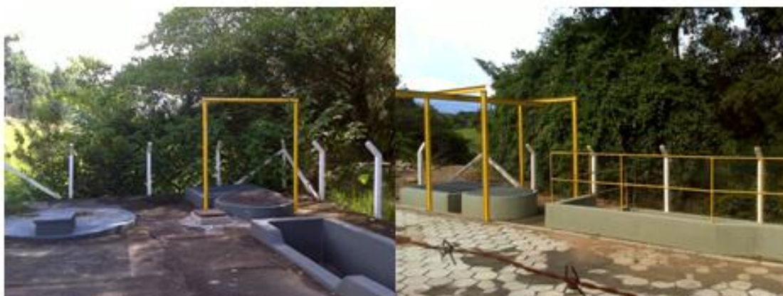
FOTO 4.17 E FOTO 4.18– ESTAÇÕES ELEVATÓRIAS DE ESGOTO QUERO QUERO (ESQUERDA) E PERDIZ (DIREITA).
