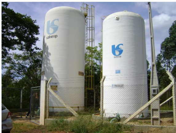
FOTO 4.10 – RESERVATÓRIOS DE 100M 3 E DE 50M 3 , QUE ABASTECE SERRINHA E VILA APARECIDA RESPECTIVAMENTE
