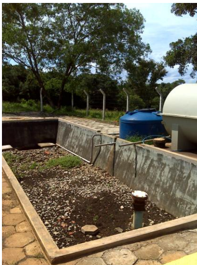
FOTO 4.21– FOSSA FILTRO VILA APARECIDA
