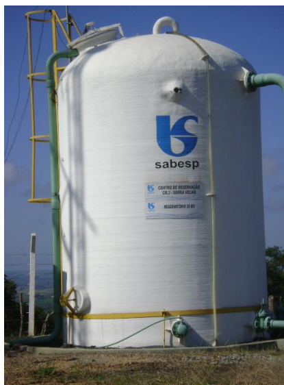
FOTO 4.12 – RESERVATÓRIO DE 25M 3 , BAIRRO SERRA VELHA.
