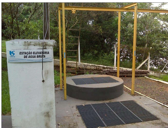
FOTO 4.2 – ESTAÇÃO ELEVATÓRIA DE ÁGUA BRUTA NA SEDE DO MUNICÍPIO DE PARANAPANEMA.
