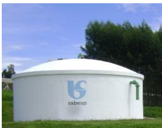
FOTO 4.9– RESERVATÓRIO DE 200M³, ETA PARANAPANEMA
