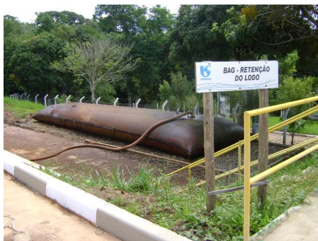
FOTO 4.4 – BAG DE RETENÇÃO DE LODO, ETA SEDE PARANAPANEMA.
