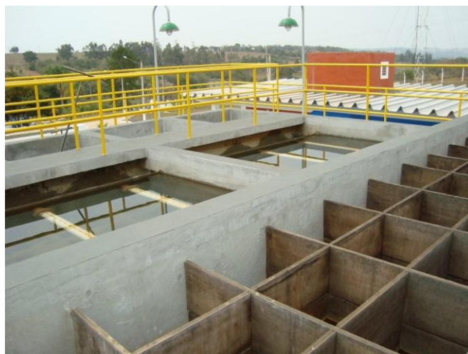
FOTO 4.3 – DECANTADORES (ESQUERDA) E FLOCULADORES (DIREITA), ETA SEDE PARANAPANEMA.
