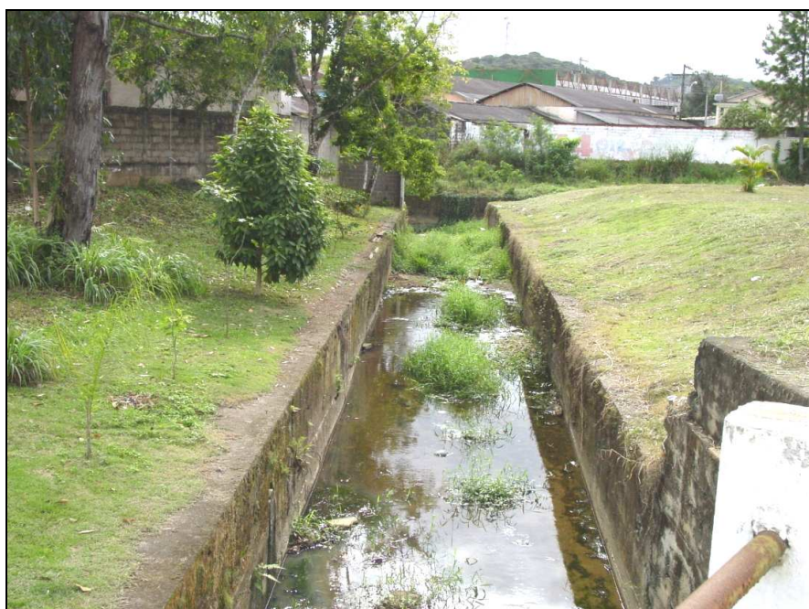
Foto 5 – Córrego Turvo. Canalização em Concreto
