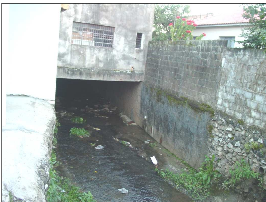
Foto 7 – Córrego Bom Retiro. Construção Sobre o seu Leito
